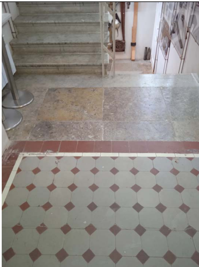
31. Объект культурного наследия федерального значения «Управление городское с оградой и воротами». Пожарная лестница. Облицовка лестничной площадки метлахской плиткой и известняковыми плитами.
