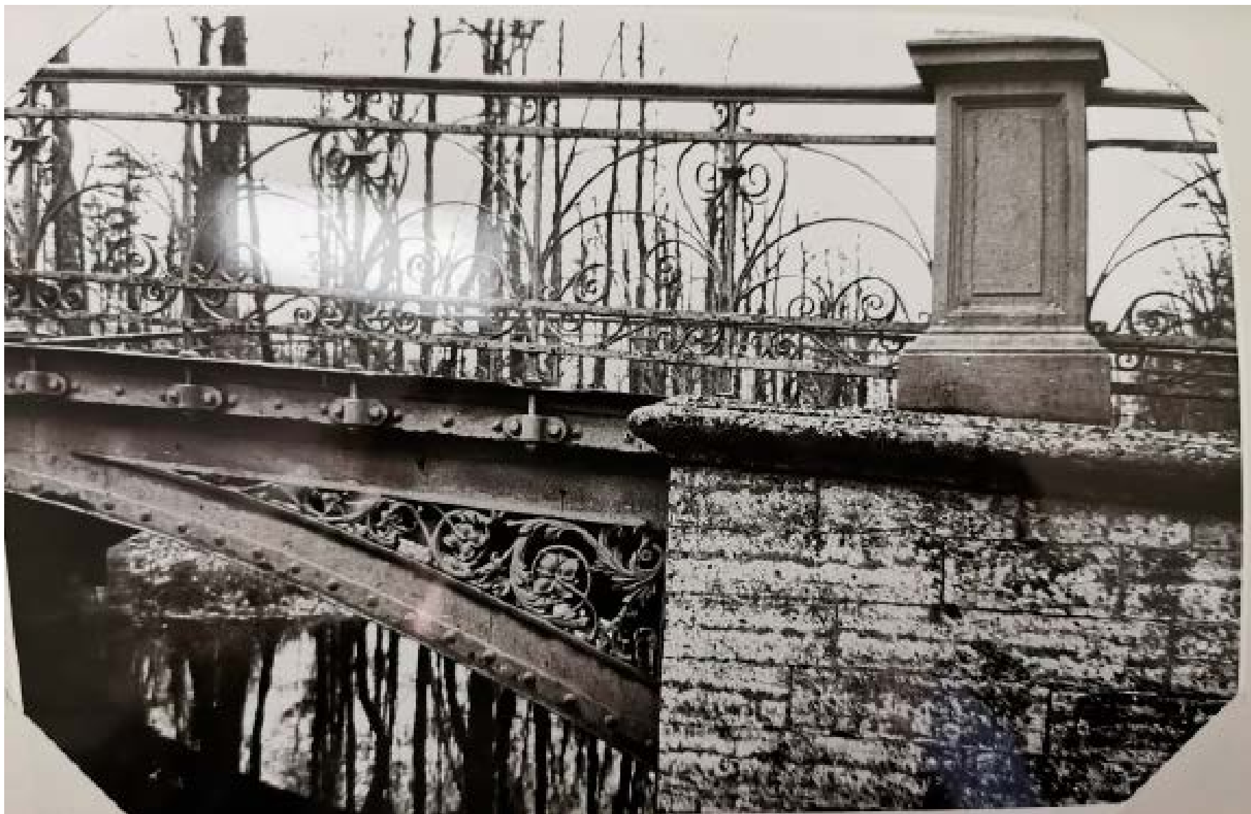
9. Фрагмент металлического моста на Крестовом канале. 1981 // Научный архив ГМЗ « Царское Село, дело №1518
