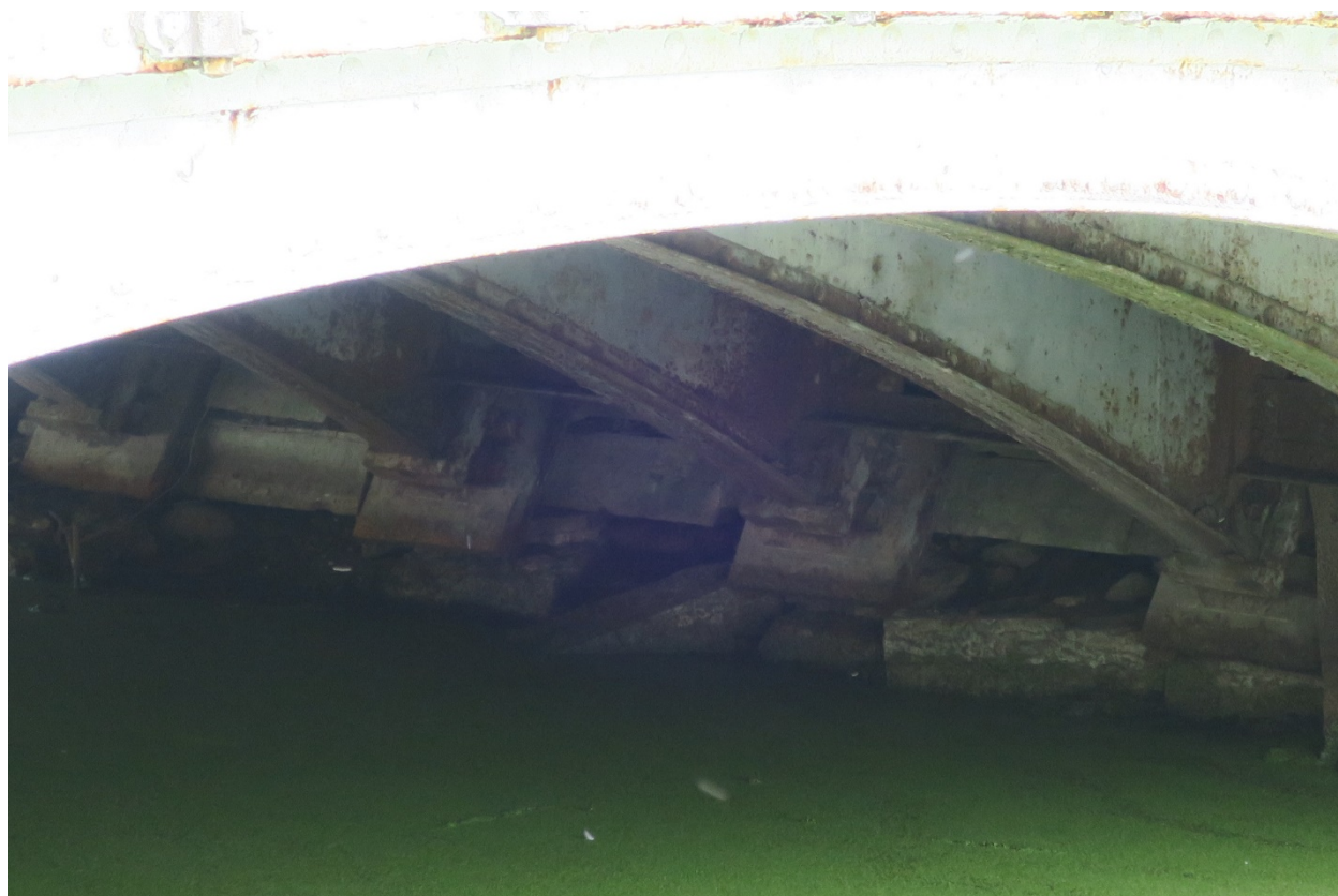
б. Арочные пролеты объекта культурного наследия федерального значения «Мост Металлический», расположенного по адресу: Санкт-Петербург, г. Пушкин, Александровский парк, литера БА. Фрагмент. 01.07.2022
