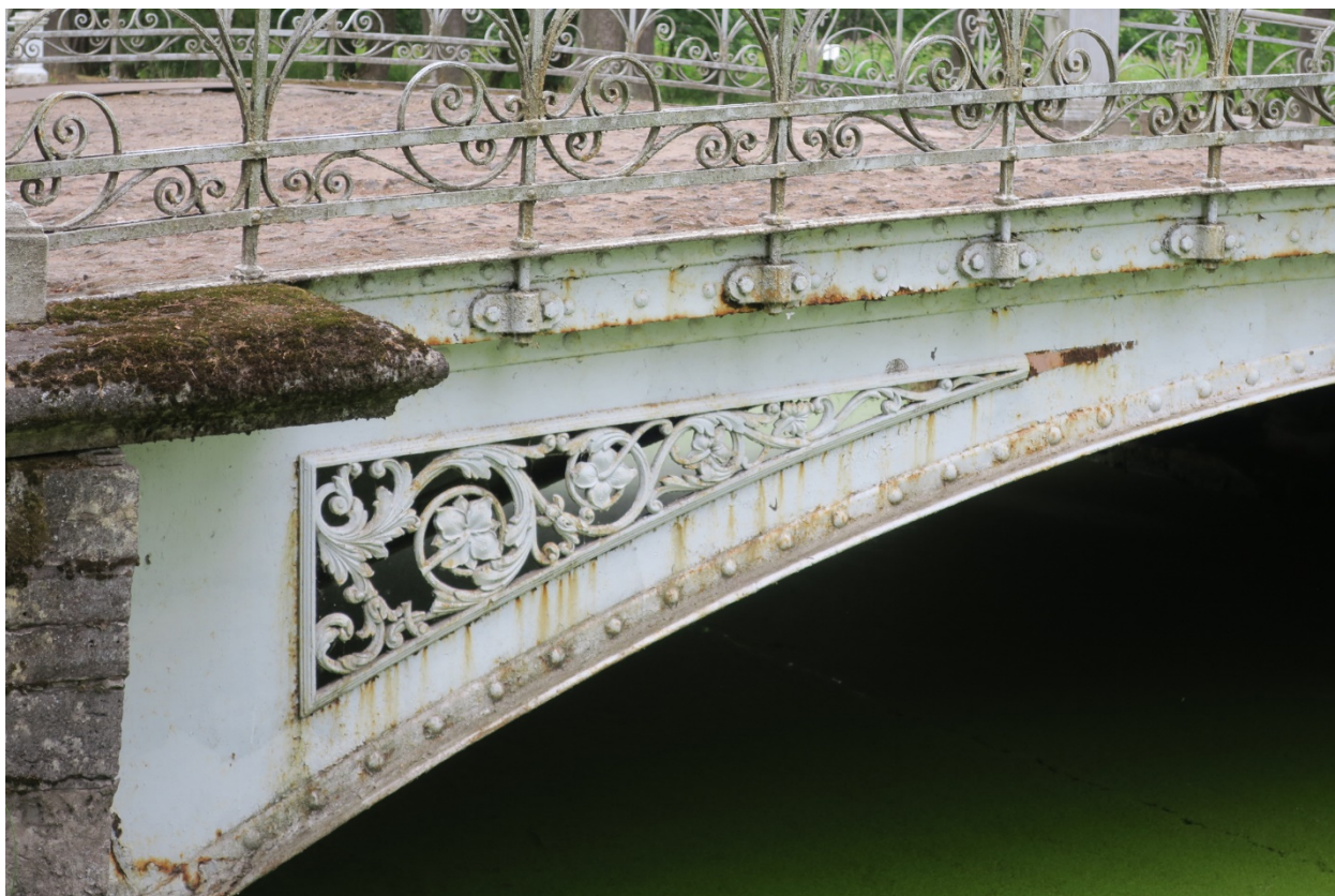
5. Низовой фасад объекта культурного наследия федерального значения «Мост Металлический», расположенного по адресу: Санкт-Петербург, г. Пушкин, Александровский парк, литера БА. Фрагмент. 01.07.2022
