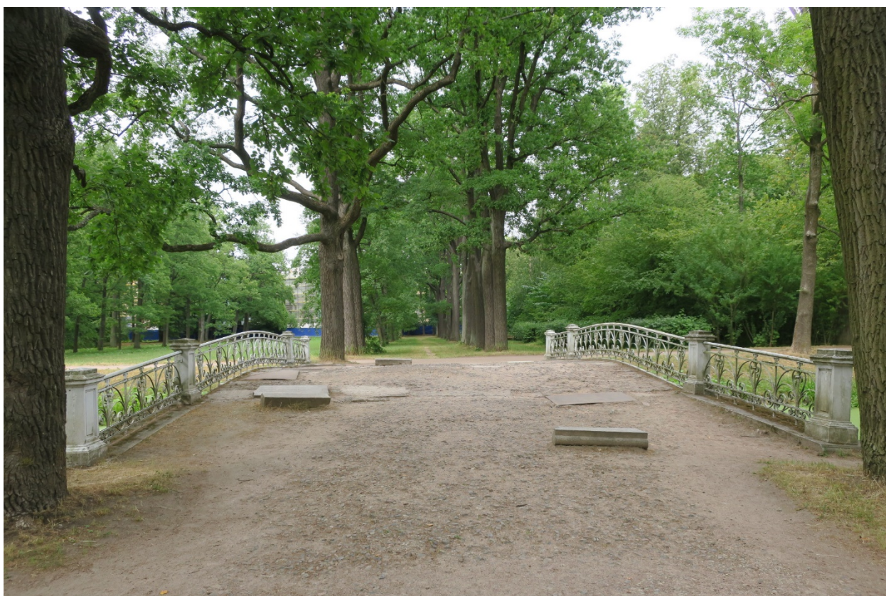
7. Проезжая часть объекта культурного наследия федерального значения «Мост Металлический», расположенного по адресу: Санкт-Петербург, г. Пушкин, Александровский парк, литера БА. 01.07.2022
