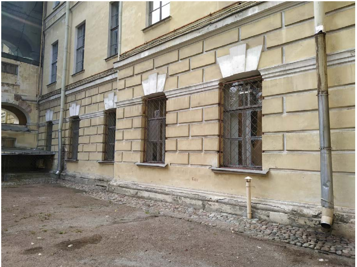
29. Фрагмент дворового (восточного) фасада главного корпуса. Неудовлетворительное состояние цоколя.
