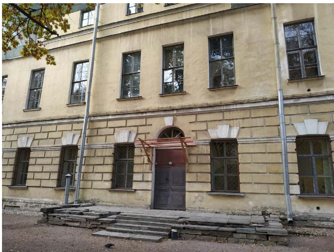
32. Неудовлетворительное состояние крыльца восточного фасада.
