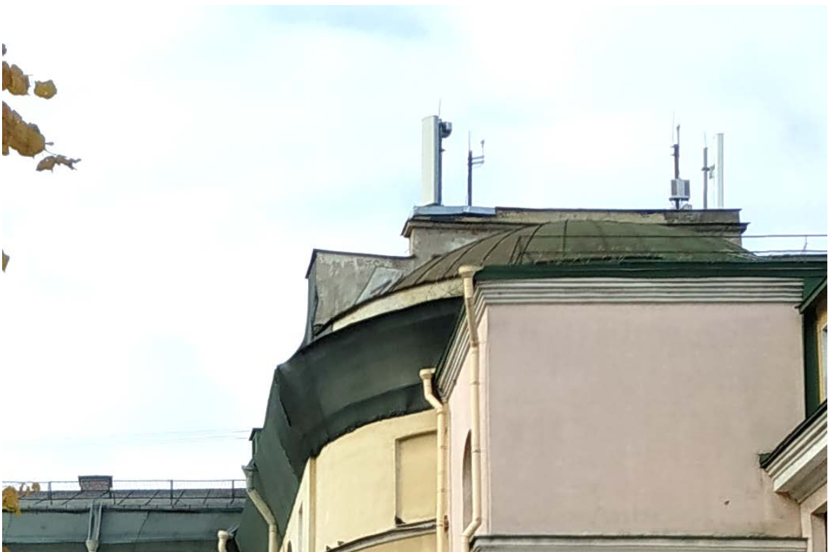
43. Крыша над апсидой церкви: неудовлетворительное состояние кровельного покрытия, утраты красочного и штукатурного слоя аттиковой стенки.
