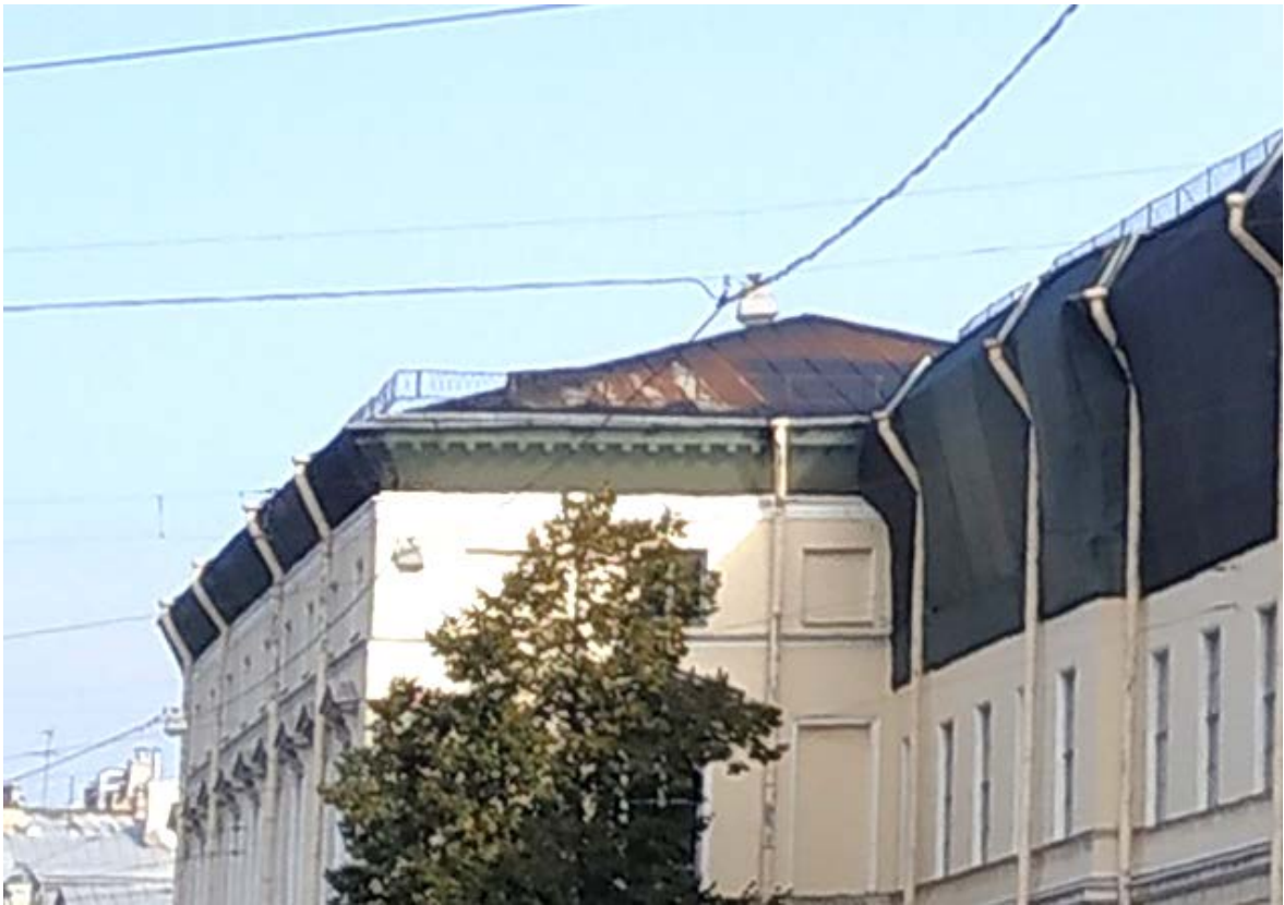
42. Крыша над северным флигелем: коррозия кровельного покрытия по всей площади ската.
