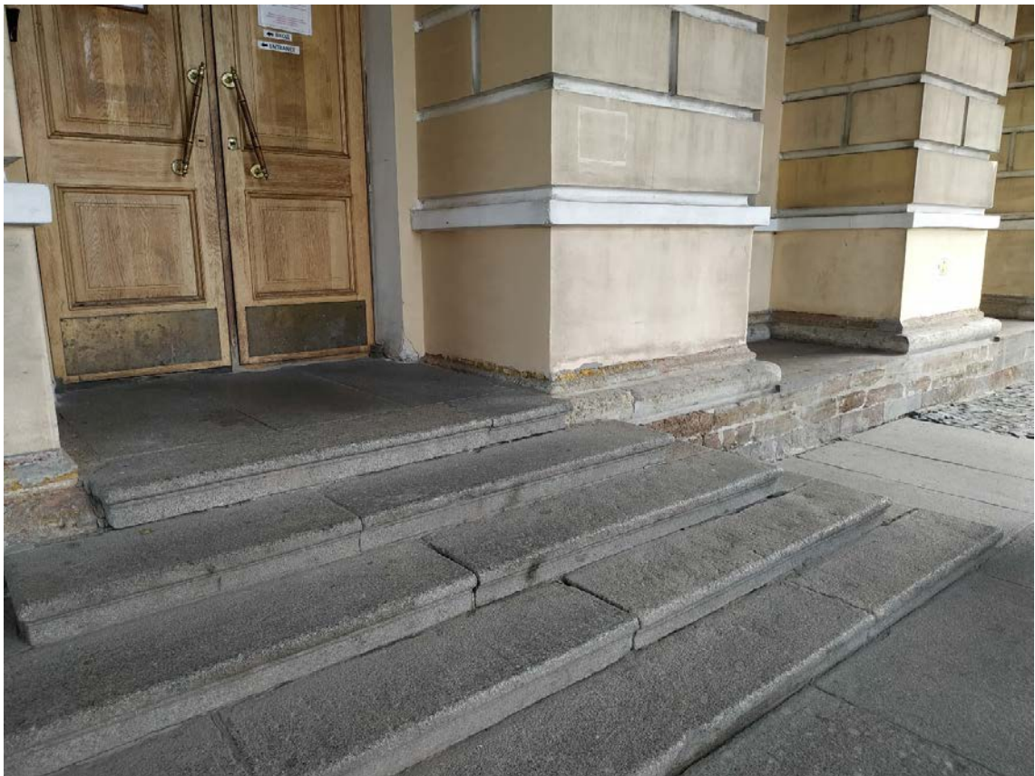
4. Гранитные ступени главного входа. Утрата шовного раствора, сколы гранита и загрязнение поверхности.
