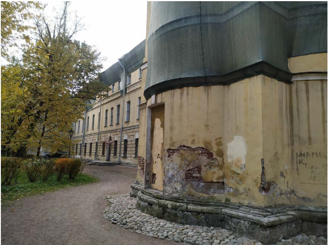
33. Утраты штукатурного слоя, деструкция кирпичной кладки, поздние обмазочные слои известнякового цоколя северного ретирадника.
