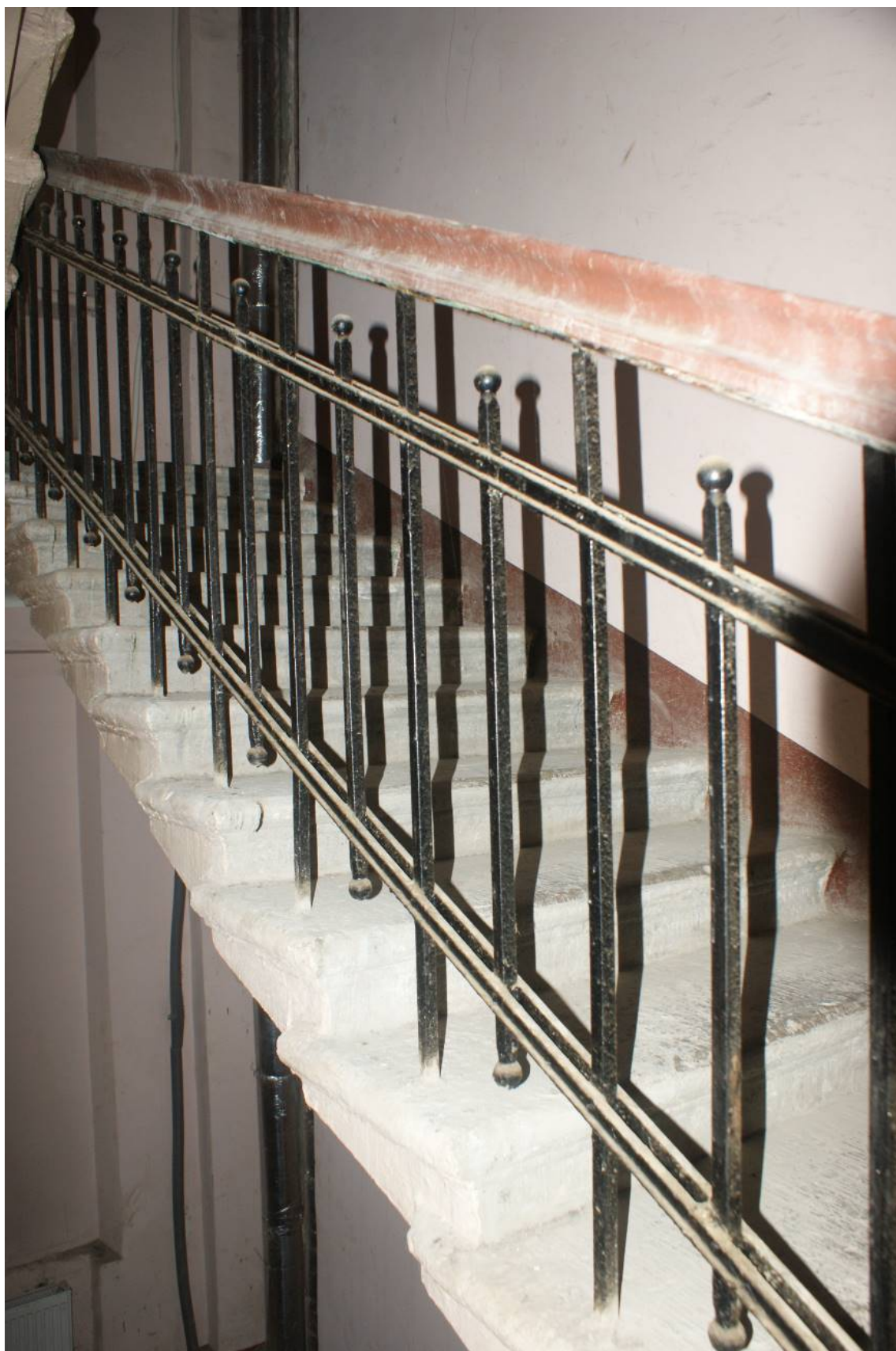
Фото 240. Лестница № 3: Площадка м/у 4-м и 5-м этажом. Фрагмент лестничного ограждения. Съемка 26.04.2021 г. Трушковский В.Э.
