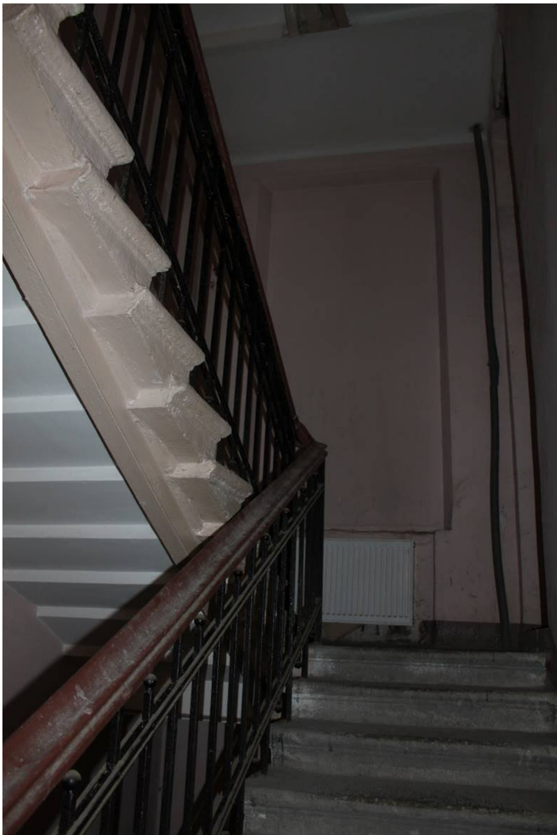
Фото 239. Лестница № 3: Площадка м/у 4-м и 5-м этажом. Съемка 26.04.2021 г. Трушковский В.Э.
