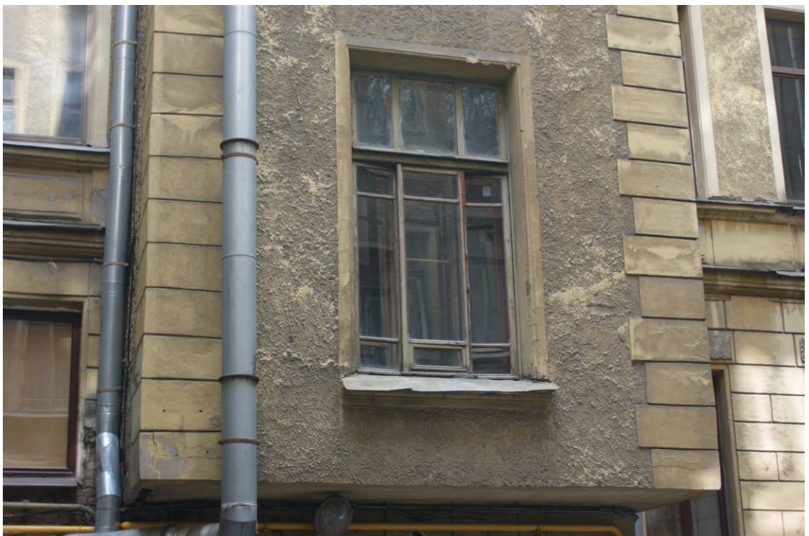
Фото 58. Здание по адресу: г. Санкт-Петербург, Кирочная ул., 22. Фрагмент южного фасада южного внутреннего двора. Ризалит. 2-й этаж. Съемка 26.04.2021 г. Трушковский В.Э.
