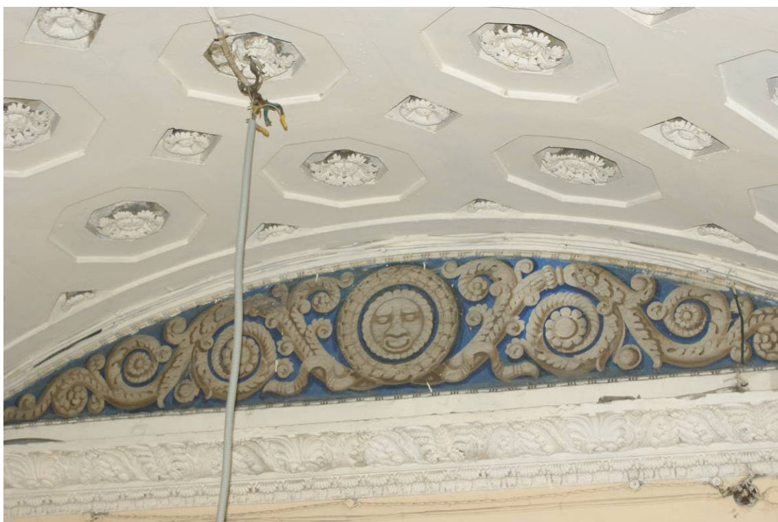
Фото 199. Лестница № 2: Площадка между 2-м и 3-м этажом. Живописная вставка в люнетах сводов. Съемка 26.04.2021 г. Трушковский В.Э.
