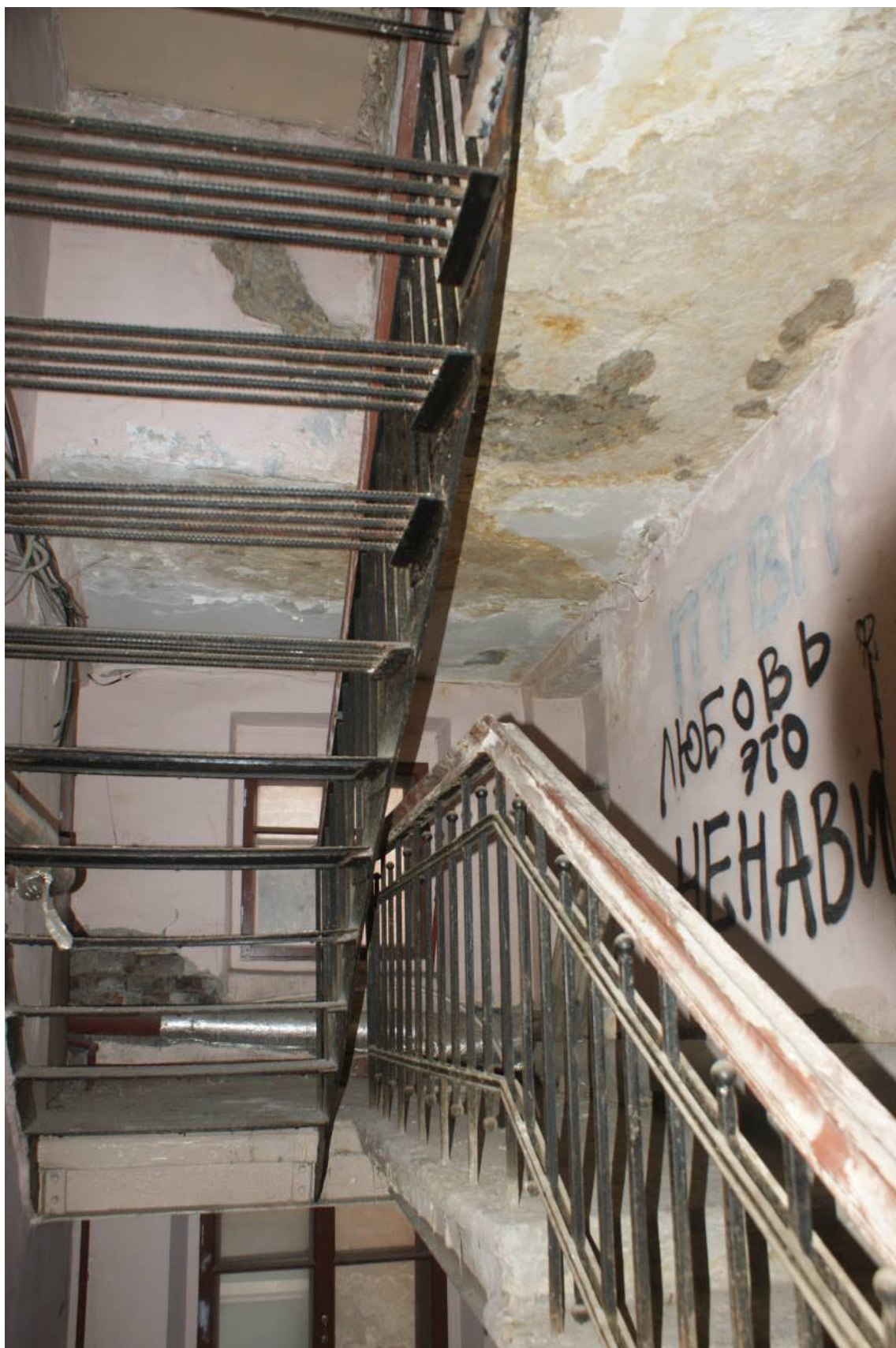
Фото 252. Лестница № 3: Площадка между техническим этажом и чердаком. Лестница на чердак. Съемка 26.04.2021 г. Трушковский В.Э.
