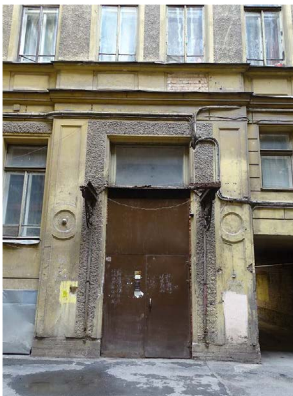
Фото 63. Здание по адресу: г. Санкт-Петербург, Кирочная ул., 22. Фрагмент северного фасада южного внутреннего двора. Вход на лестницу №2. Съемка 26.04.2021 г. Трушковский В.Э.
