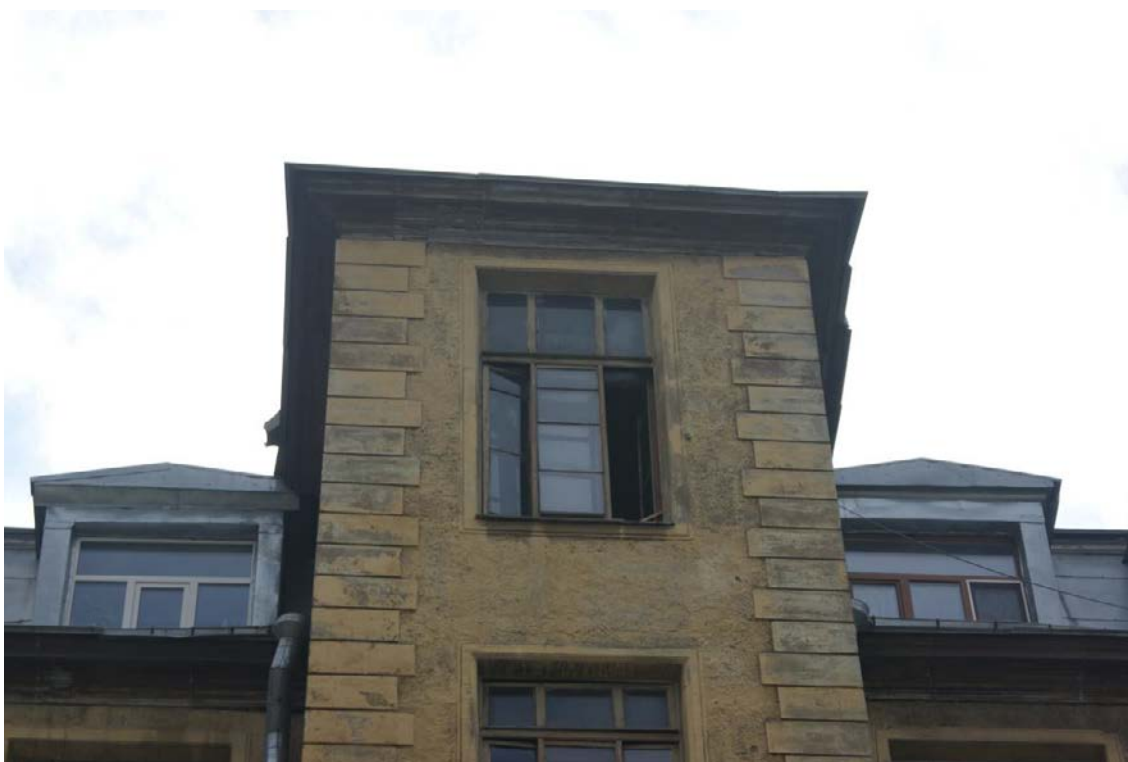
Фото 70. Здание по адресу: г. Санкт-Петербург, Кирочная ул., 22. Фрагмент южного фасада северного внутреннего двора. Ризалит. 6-й этаж. Съемка 26.04.2021 г. Трушковский В.Э.
