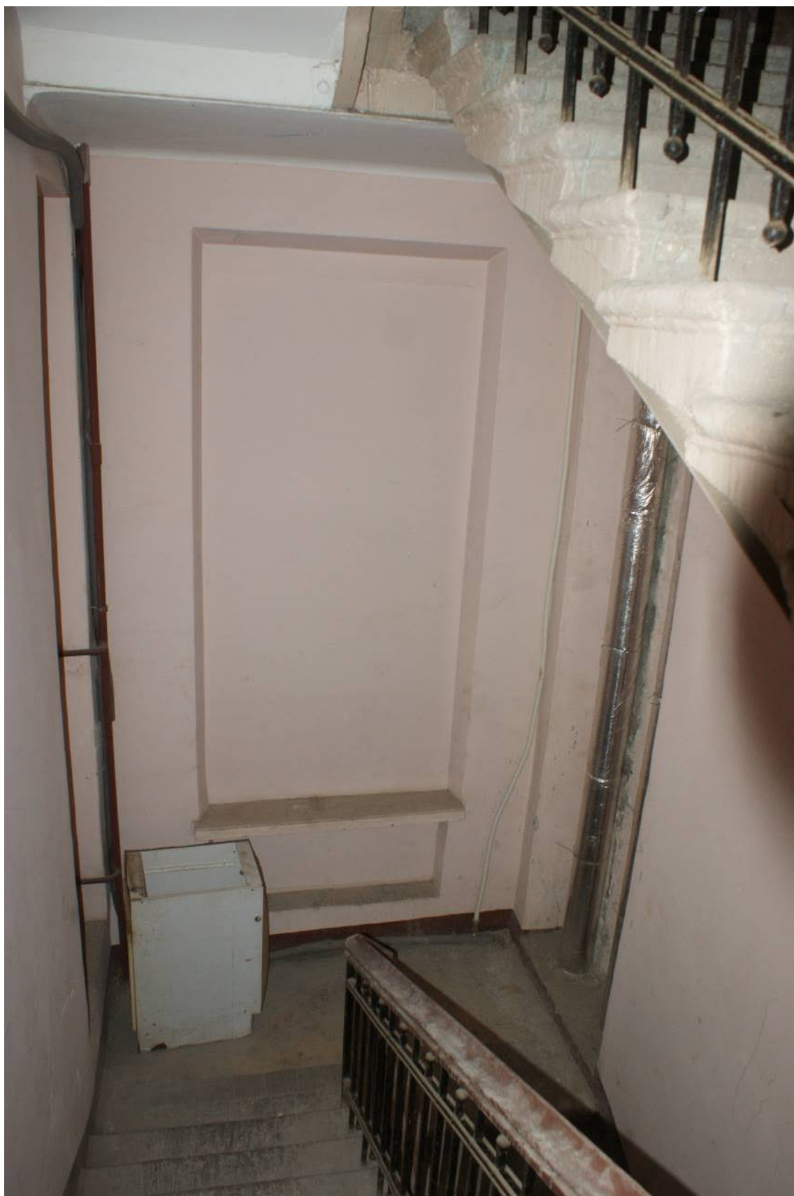
Фото 243. Лестница № 3: Площадка м/у 5-м и 6-м этажом. Съемка 26.04.2021 г. Трушковский В.Э.
