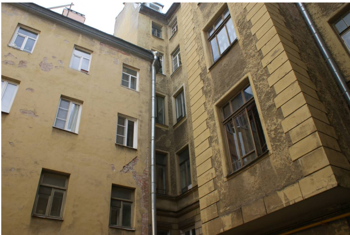
Фото 72. Здание по адресу: г. Санкт-Петербург, Кирочная ул., 22. Фрагмент восточного и южного фасада северного внутреннего двора. 1-й, 2-й, 3-й, 4-й этаж. Съемка 26.04.2021 г. Трушковский В.Э.
