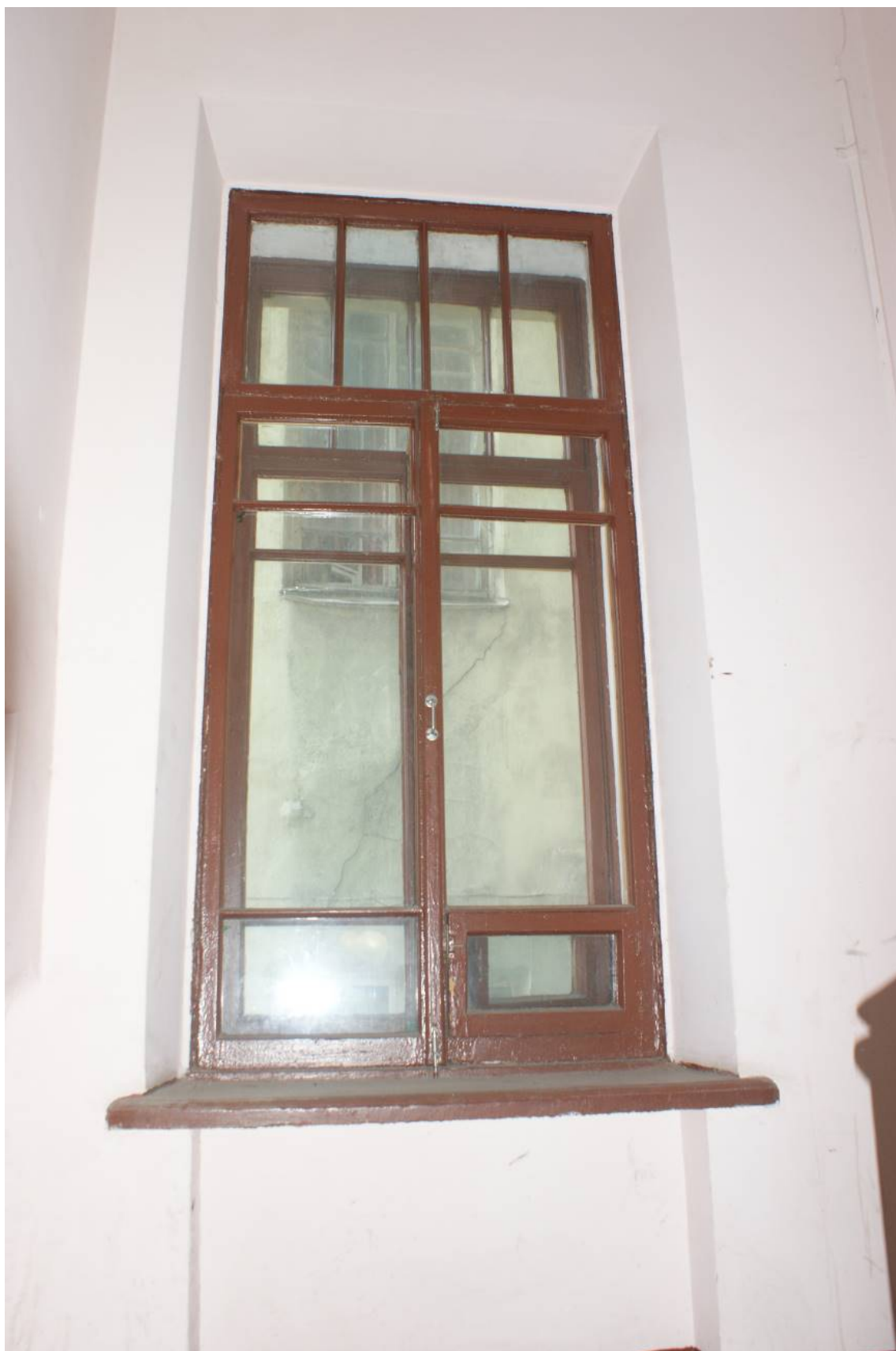
Фото 259. Лестница № 6: Площадка между 2-м и 3-м этажом. Оформление окна. Съемка 26.04.2021 г. Трушковский В.Э.
