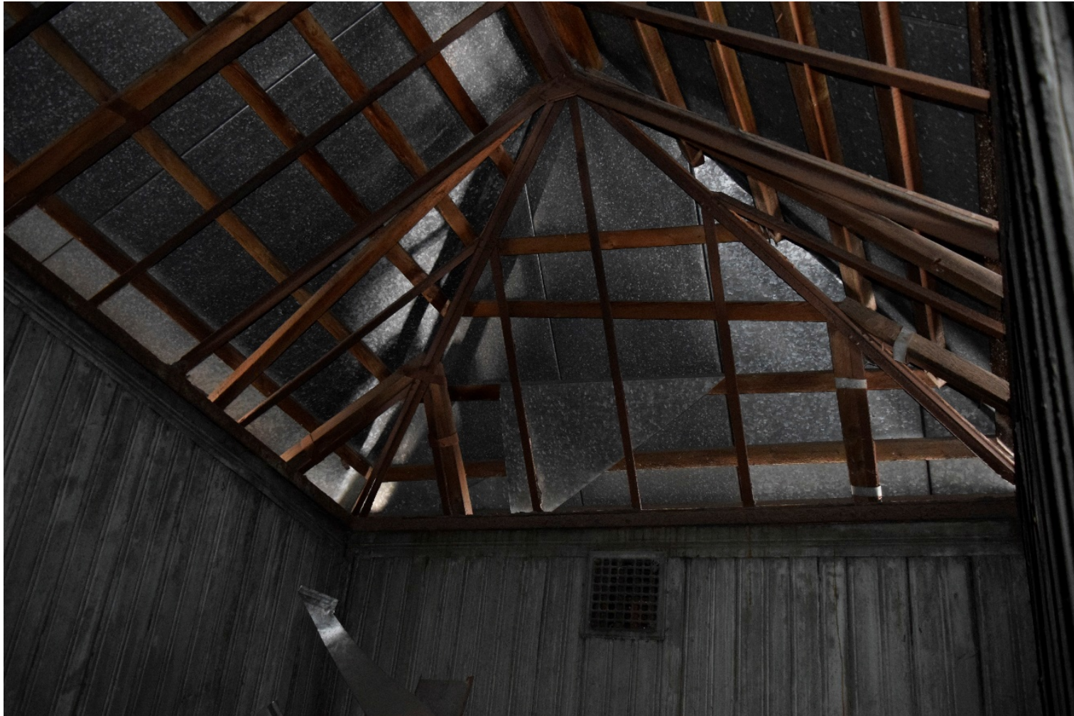
36. “Дом А.Ф. Кларка (здание общества «Мазут») Английская наб., д. 38, лит. А. Фонарь над лестницей №2. Фрагмент. Фото:01.02.21.
