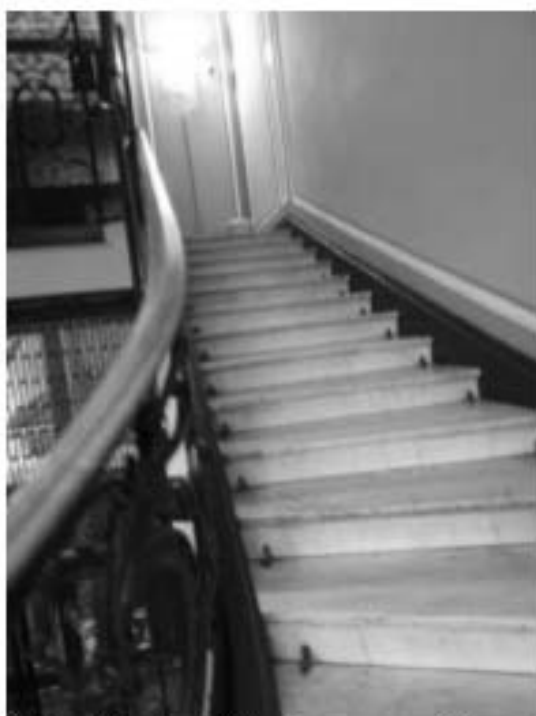
117. «Особняк Штифтер», ул. Моховая, д.15, лит.А. Лестничный марш на площадку 4-го этажа. Фото 01.12.2020г.
