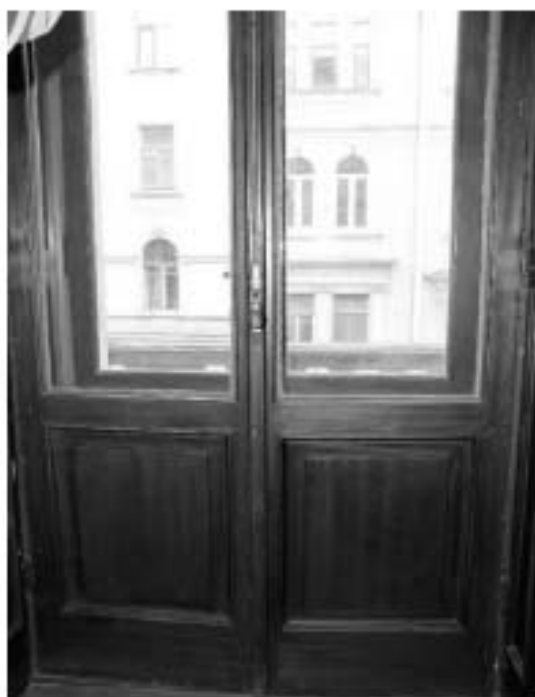
87. «Особняк Штифтер», ул. Моховая, д.15, лит.А. Помещение 3.4. Фрагмент балконной двери. Фото 01.12.2020г.
