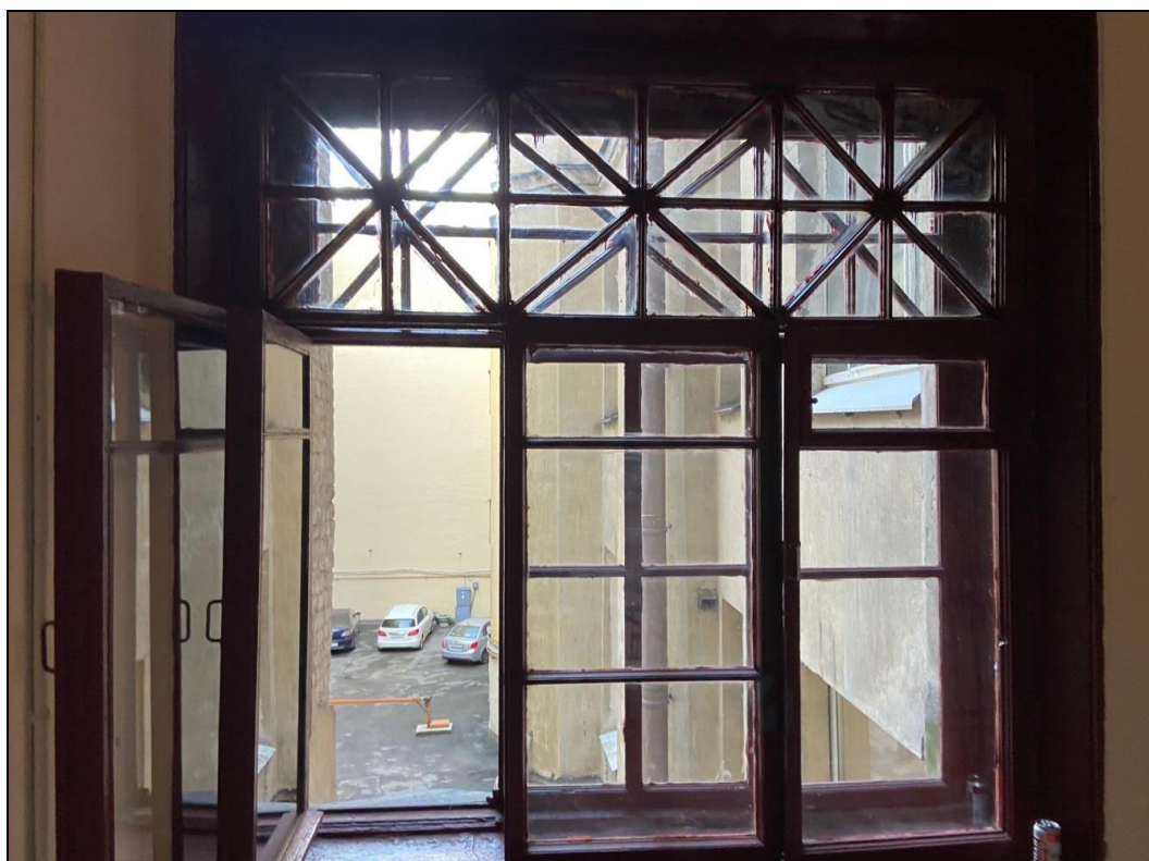
30. Флигель. Окно лестничной клетки. Дата съемки: 19 октября 2020 г. Фотограф: В. П. Орлов.
