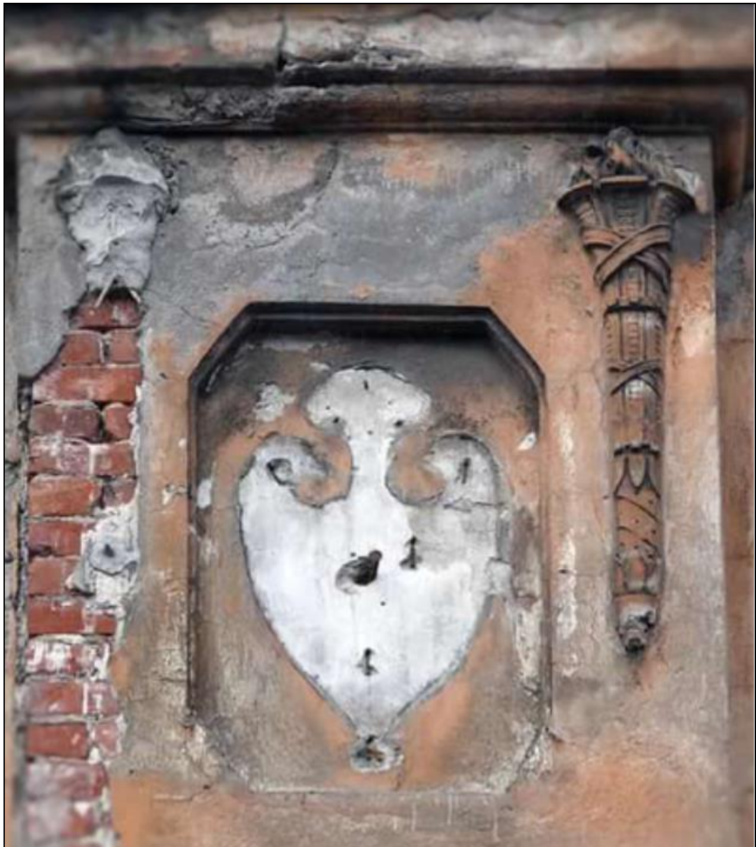
17. Лицевой фасад по Канонерской улице. Фрагмент. Утраты лепного декора в верхней части лопатки в уровне между четвертым и пятым этажами. Дата съемки: 19 октября 2020 г. Фотограф: В. П. Орлов.
