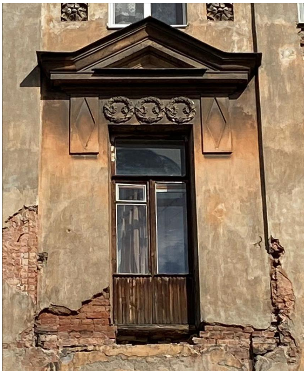
11. Лицевой фасад по Канонерской улице. Оформление балконного проема в уровне четвертого этажа. Дата съемки: 19 октября 2020 г. Фотограф: В. П. Орлов.
