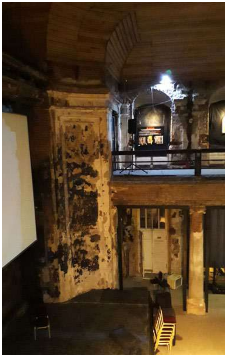
Фото 25. Объект культурного значения федерального значения «Церковь», 1775-1779гг, арх. Фельтон Ю.М., 1939г. арх. Гегелло А.И, арх. Косвен Л.С., по адресу: г. Санкт-Петербург, ул. Кирочная, дом 8, лит. В, входящего в состав объекта культурного наследия федерального значения "Церковь евангелическо-лютеранская Святой Анны" по адресу: г. Санкт-Петербург, Кирочная ул., дом 8, Фурштатская ул., между домами 7 и 9.
