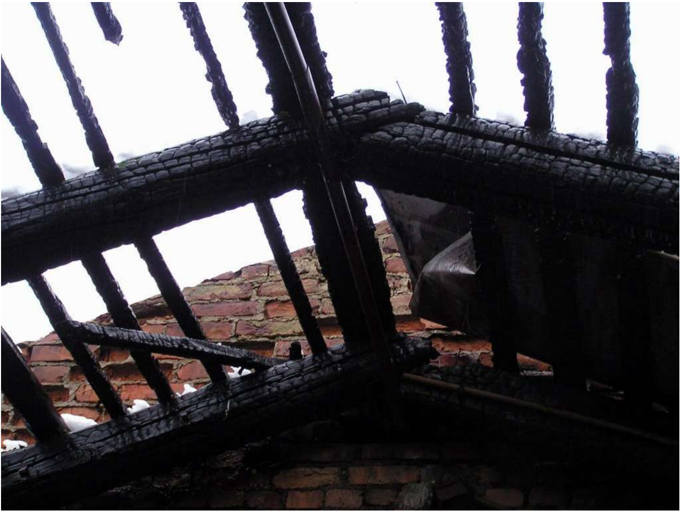
Рис. 97. Кинотеатр «Спартак» после пожара. Стропильная система крыши. Интернет-ресурс.
