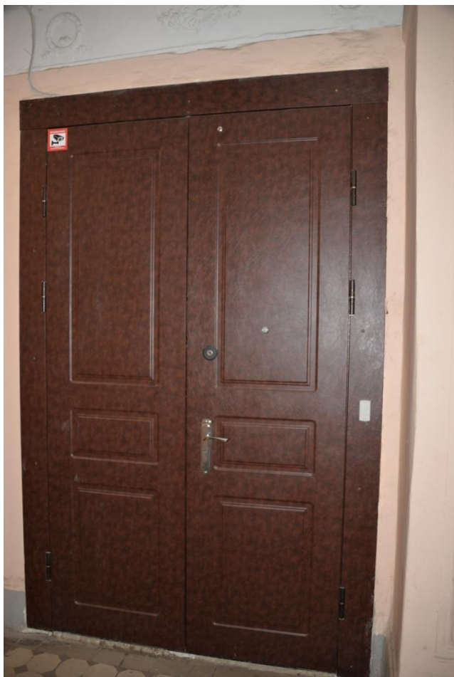
6. Входная дверь в квартиру №2
