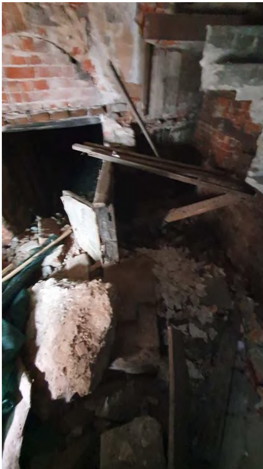
Фото 22 1-й этаж исследуемого объекта культурного наследия регионального значения «Жилой дом Степанова В.Ф.», остатки дворовой лестницы. Автор Митяев П.А.
