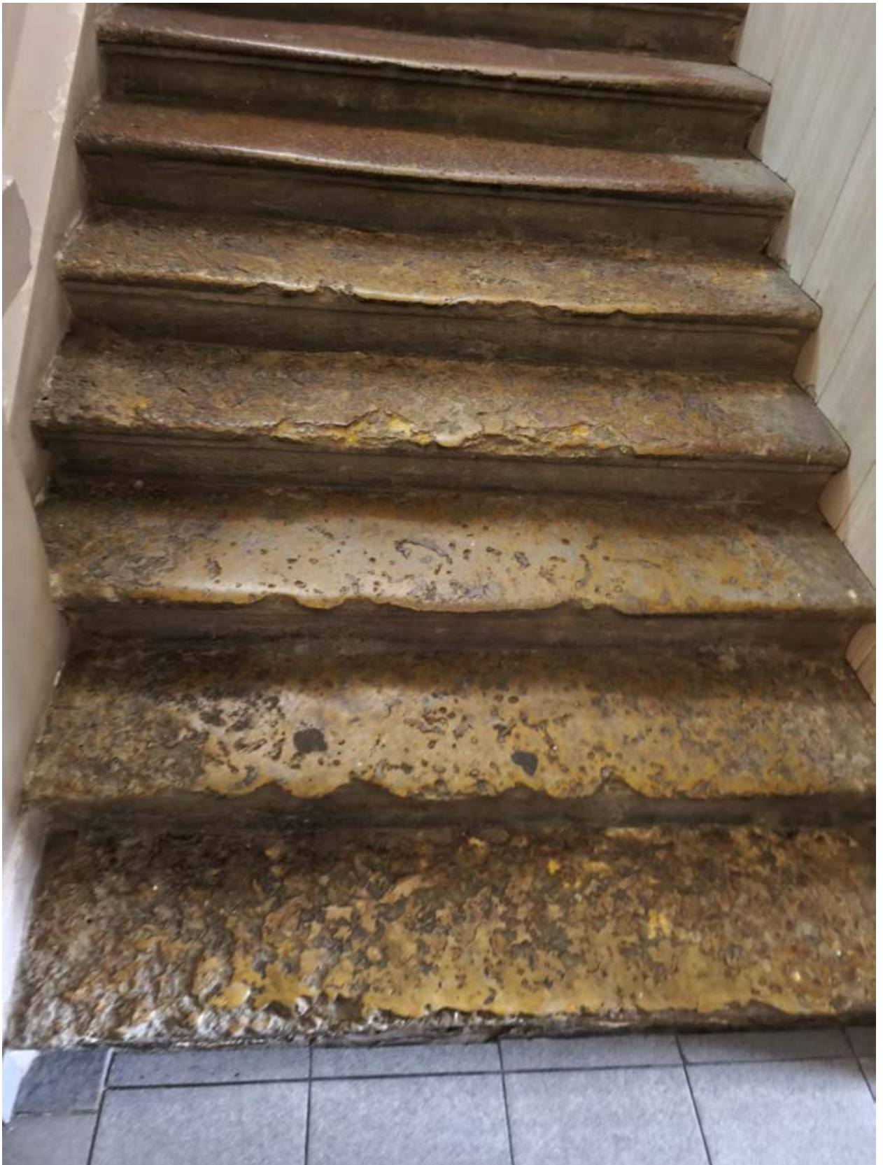
Фото 12. Фрагмент главной лестницы. Дефекты ступеней;
