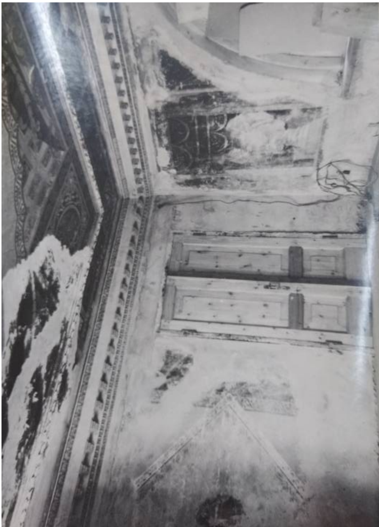
113. Дача Безобразова. Фрагмент росписи стены и плафона потолка. Устроенное перекрытие. 1951 г. Архив КГИОП. П 32. Фототека. № 7280/2
