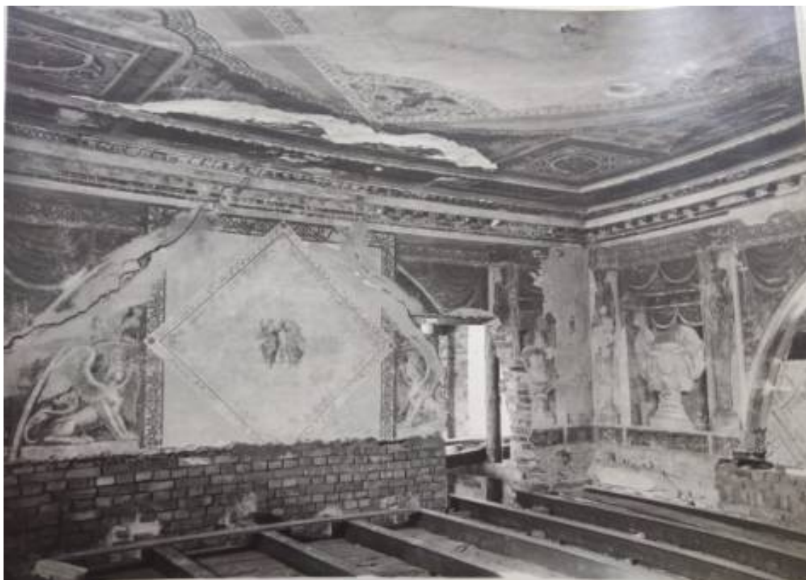
112. Дача Безобразова. Фрагмент росписи стены и плафона потолка. Устроенное перекрытие. 1950 г. Архив КГИОП. П 32. Фототека. № 31914/3
