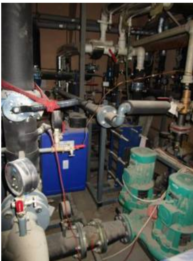
Рисунок 13 – ИТП №4 Федоровского корпуса.
