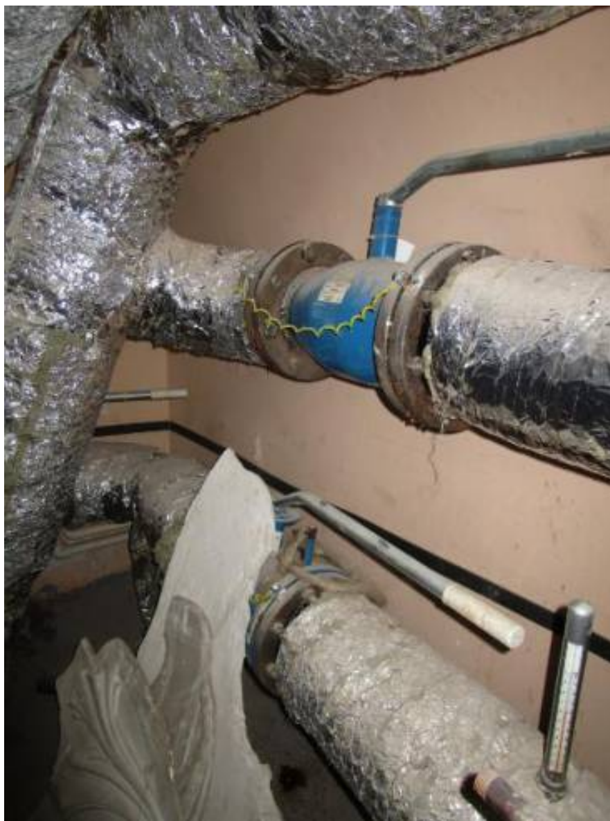
Рисунок 12 – Ввод тепловой сети в здание Федоровского корпуса.
