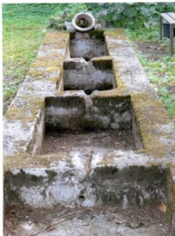
Фото 14: фрагмент объекта: каскад (наблюдается деструкция камня, сколы, трещины, очаги биопоражения, высолы, на отдельных участках зарастает сорной травянистой растительностью).
