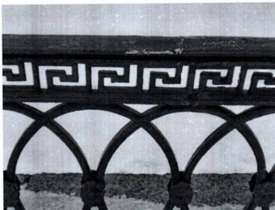
Фото № 3: фрагмент объекта культурного наследия. Вид с северной стороны (фрагмент металлического ограждения, наблюдаются утраты окрасочного слоя, коррозия металла).
