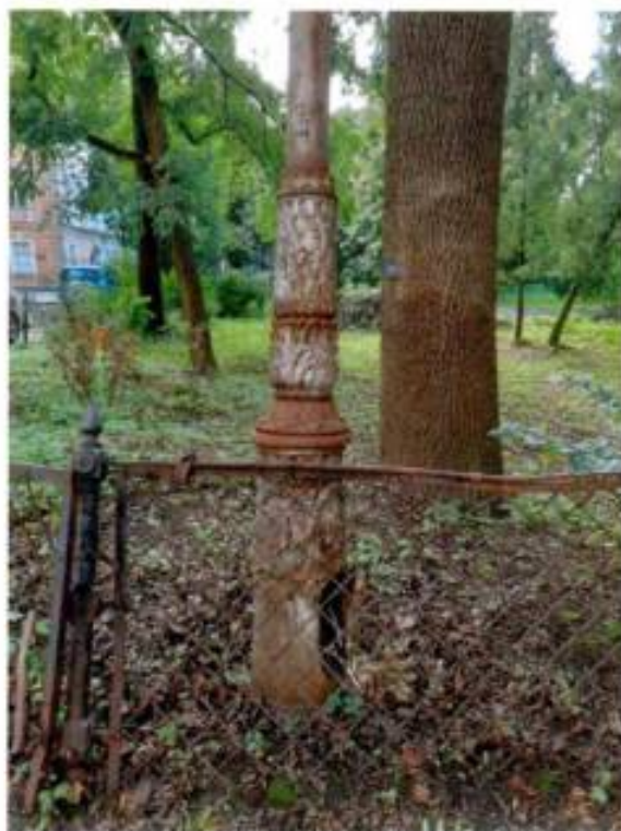
Фото 17: фрагмент объекта: историческая чугуная фонарная опора (наблюдается коррозия металла, загрязнения, механические повреждения).
