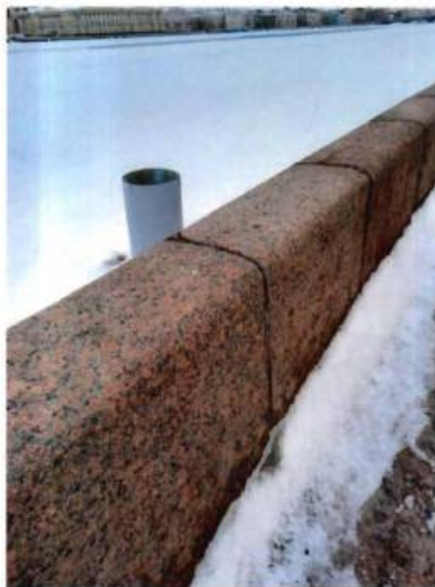
Фото 5: фрагмент перильного ограждения объекта культурного наследия.
