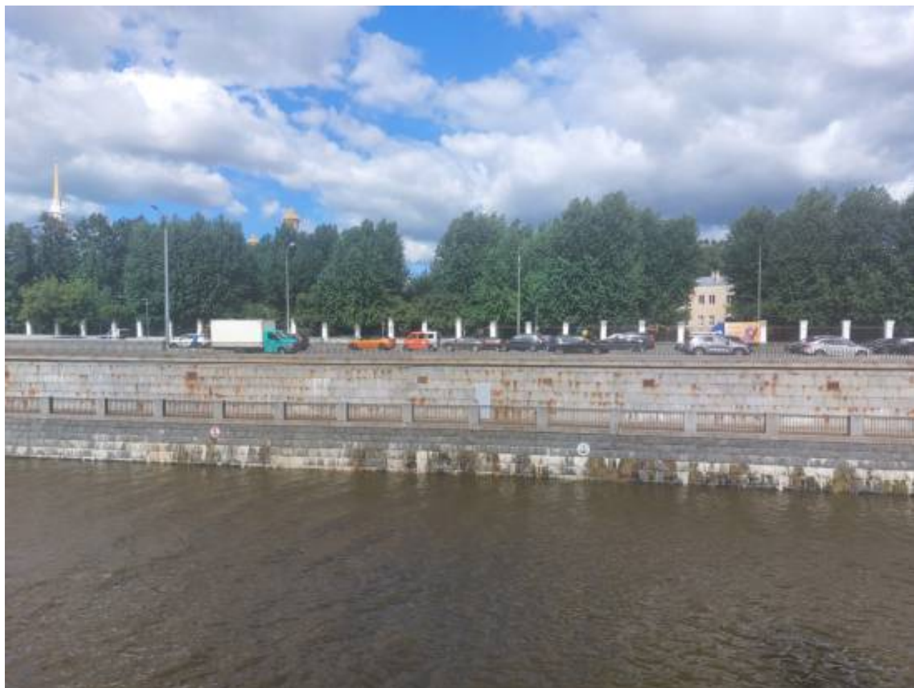
4. Набережная Обводного канала, правый берег. Нижний ярус с облицовкой более темного цвета - объект культурного наследия регионального значения "Набережная Обводного канала". Высолы на облицовке
