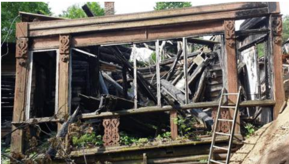
21. ОКН РЗ «Дача Гербель» по адресу: г.Санкт-Петербург, ул. Межозёрная, дом 4, литера А. Восточный фасад. Дата съёмки: 19.06.2019 г.
