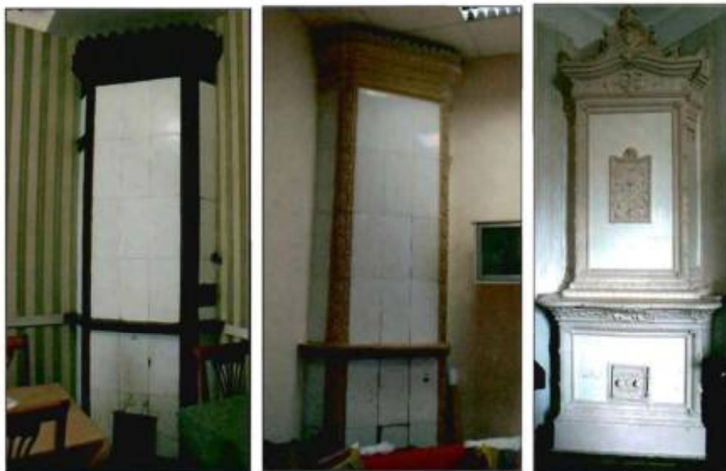
Фото №17-19. Печь угловая (кв. 29, 30, пом. 52-Н).
