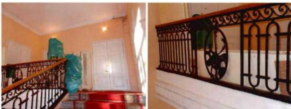
73, 74. Интерьеры и техническое состояние квартир (кв. 46, 47, 48)
