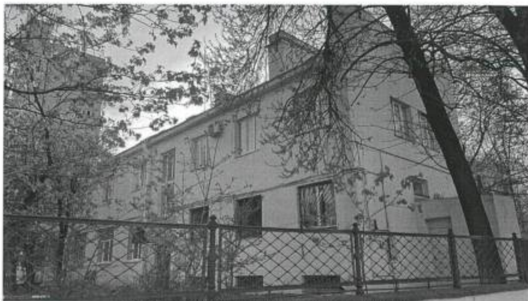
2. Вид на южный фасад объекта культурного наследия На южном фасаде объекта культурного наследия зафиксировано устройство 1 наружного блока системы кондиционирования
