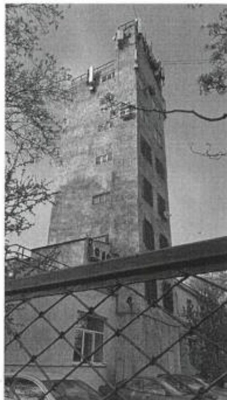
5. Фрагмент южного фасада и каланчи объекта культурного наследия. На фасадах каланчи объекта культурного наследия зафиксировано устройство сетей связи и 3х наружных блока системы кондиционирования.
