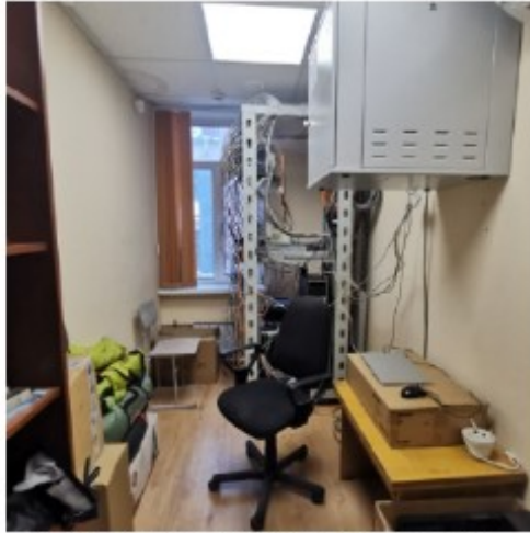
Фото 19. Пом. 7. Серверная. Общий вид.
