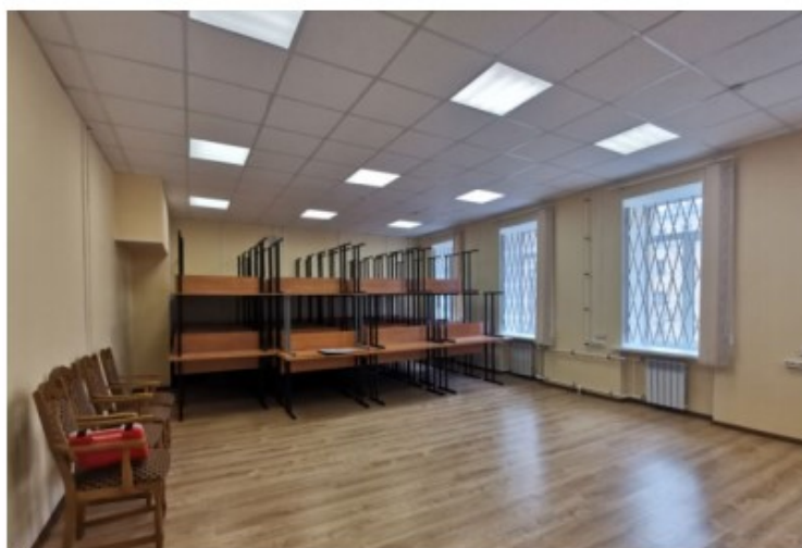
Фото 15. Пом. 5. Компьютерный класс. Общий вид
