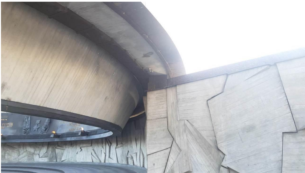
15. «Монумент героическим защитникам Ленинграда» (Победы пл., соор. 1, лит. А). Фото мест установки оборудования и прокладки кабельных трасс. Штиглиц М.С. 07.08.2026 г.
