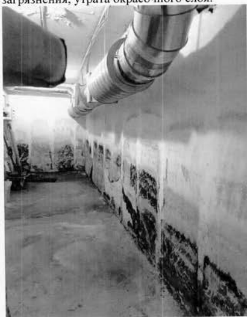
28. Помещение 1-Н, ч.п. 53. Биопоражения, загрязнения, утрата окрасочного слоя.
