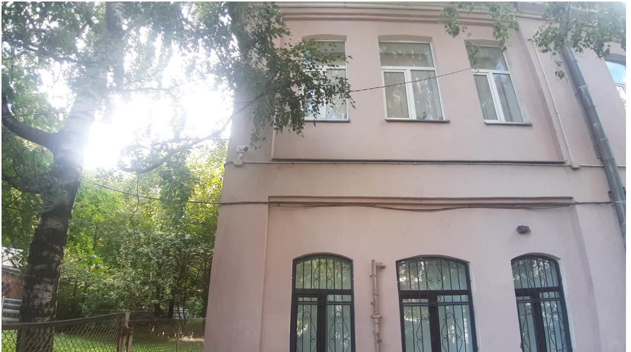
3. «Флигель» (в составе «Богадельня и детский приют Мещанского общества» (Детский пер., д. 3, лит. Б). Лицевой фасад (фрагмент). Фото мест установки оборудования и прокладки кабельных трасс. Штиглиц М.С. 07.08.2026 г.
