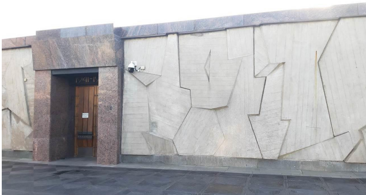
19. «Монумент героическим защитникам Ленинграда» (Победы пл., соор. 1, лит. А). Фото мест установки оборудования и прокладки кабельных трасс. Штиглиц М.С. 07.08.2026 г.
