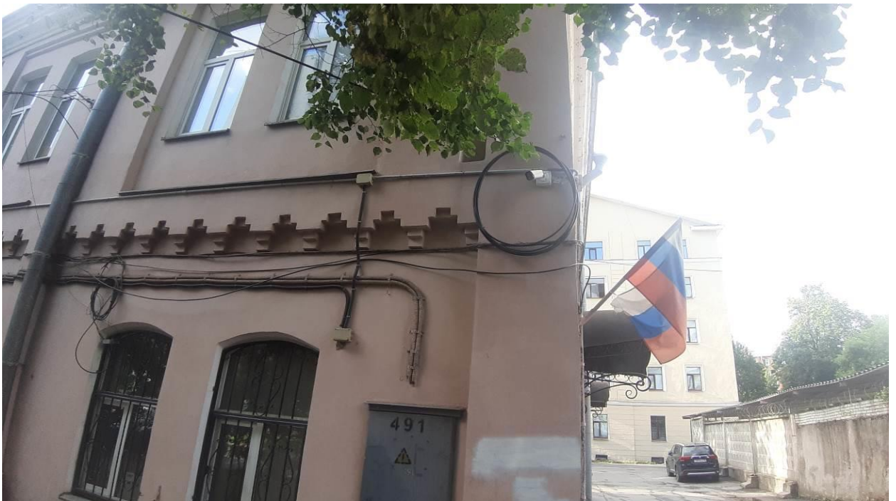
4. «Флигель» (в составе «Богадельня и детский приют Мещанского общества» (Детский пер., д. 3, лит. Б). Лицевой фасад (фрагмент). Фото мест установки оборудования и прокладки кабельных трасс. Штиглиц М.С. 07.08.2026 г.
