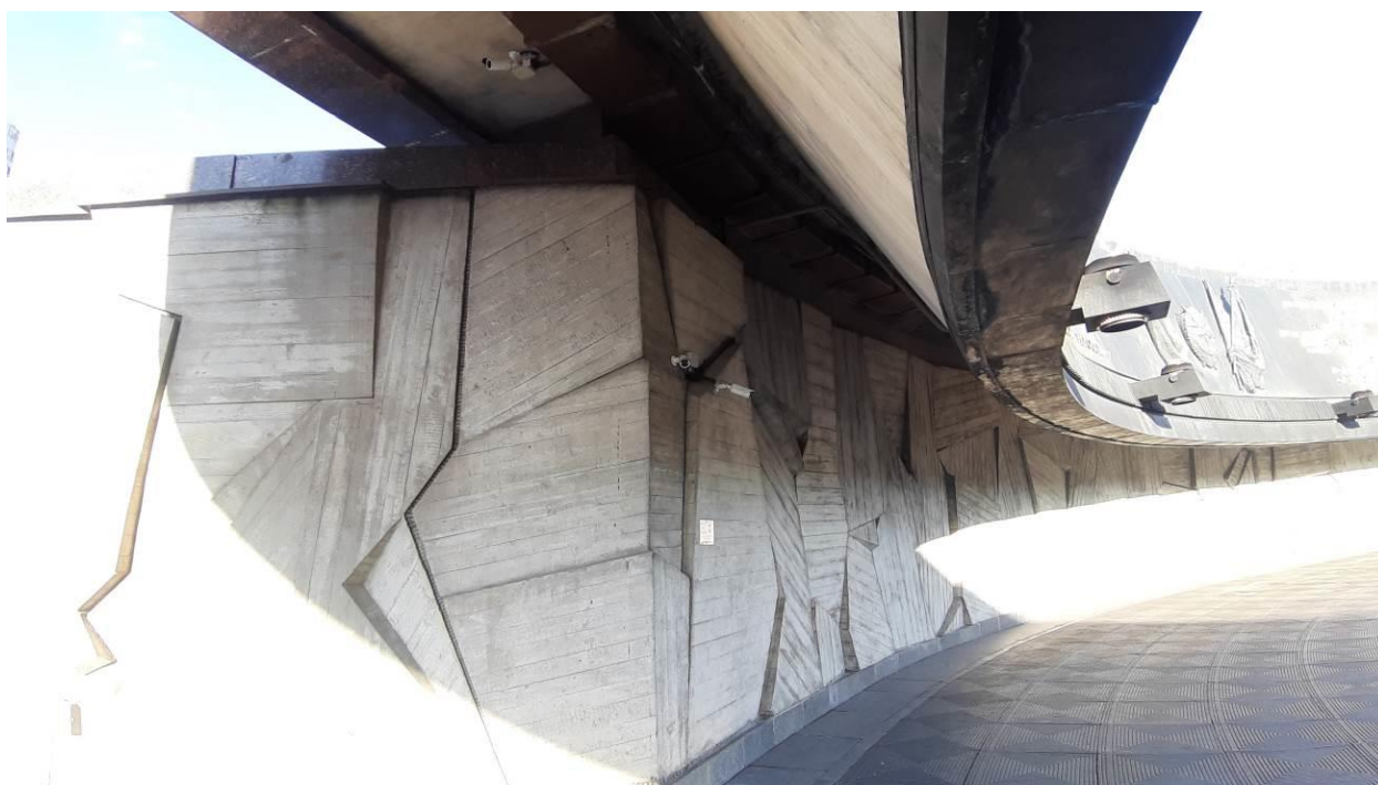
16. «Монумент героическим защитникам Ленинграда» (Победы пл., соор. 1, лит. А). Фото мест установки оборудования и прокладки кабельных трасс. Штиглиц М.С. 07.08.2026 г.
