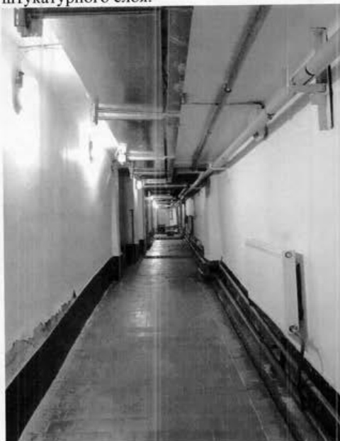
27. Коридор помещения 1-Н, ч.п. 58 (2-й подземный этаж). Деструкция штукатурного слоя.
