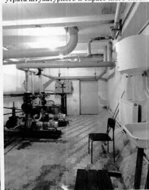
29. Помещение 1-Н, ч.п. 71. Загрязнения, утрата штукатурного и окрасочного слоев.
