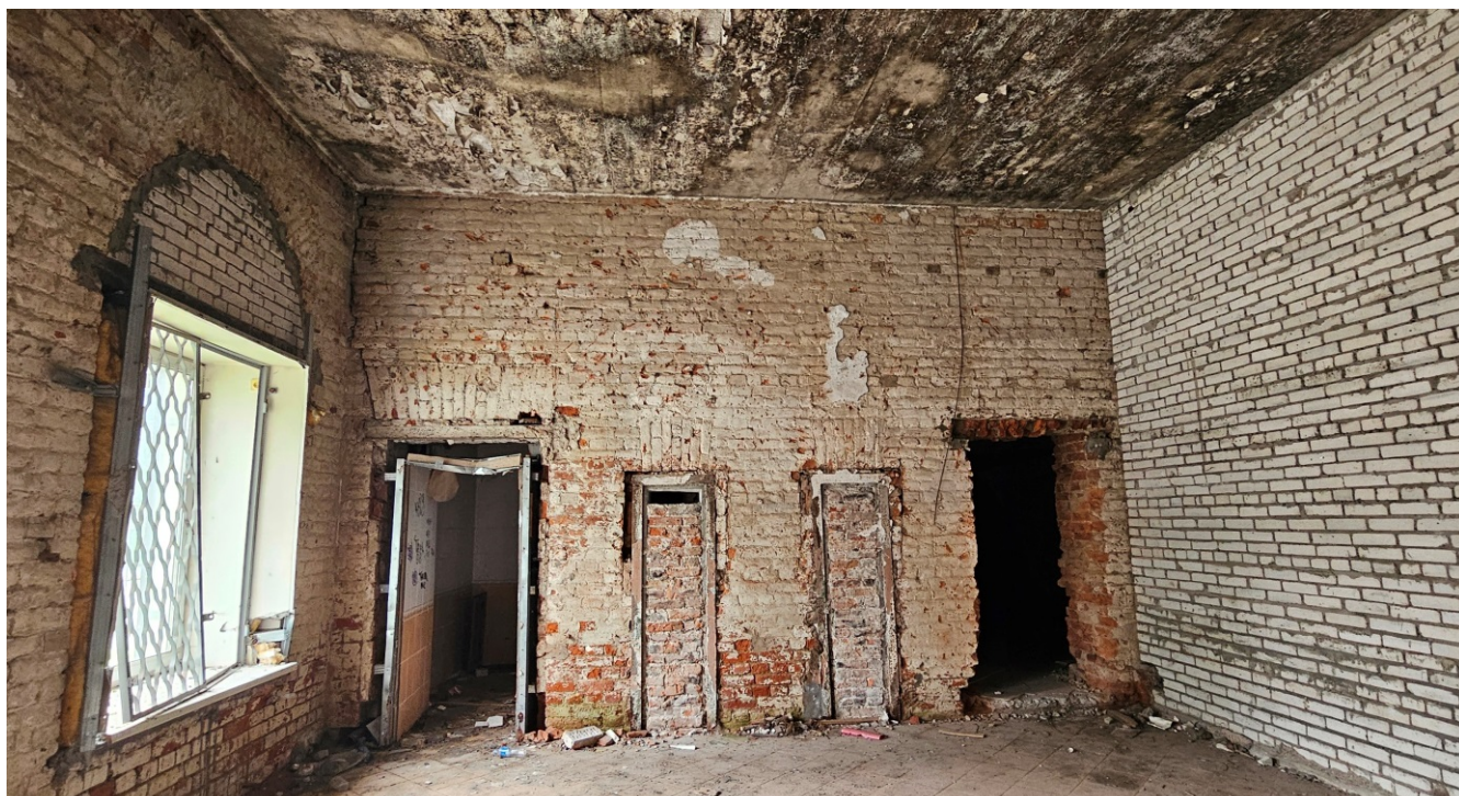
22. 1 эт., пом.3. Общий вид помещения. Состояние проемов в южной капитальной стене.
