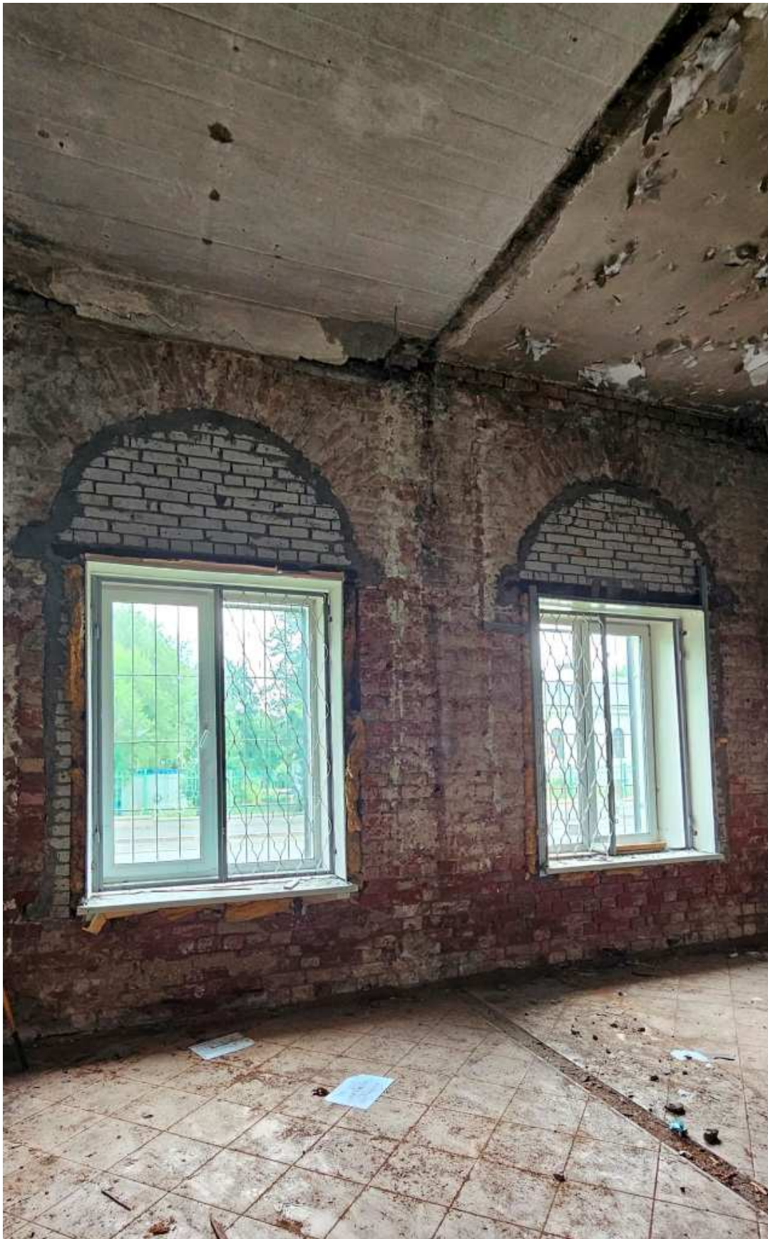
16. 1 эт., пом.1. Частично заложённые оконные проёмы в восточной капитальной стене.
