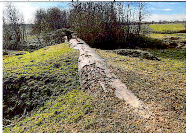
Фото 25. Подходной участок полуподземной галереи к акведуку. Нарушение защитного слоя, деструкция поверхности кирпича
