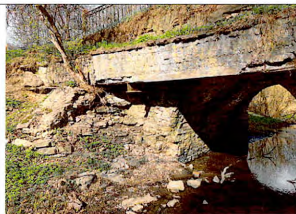
Фото 101. Павловск, ул. Правды. Водопроводный мост, разрушение южного фасада
