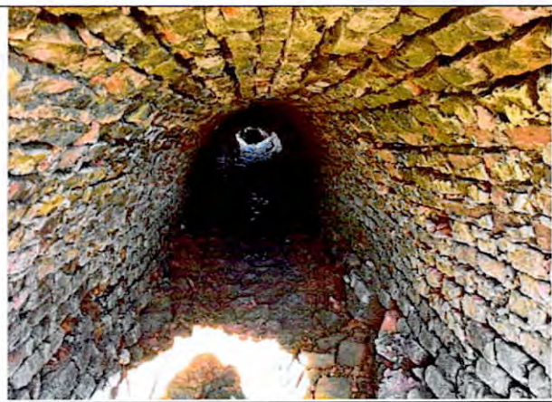
Фото 36. Вид кирпичного водовода изнутри. Утрата шовного раствора, вывалы кирпича, биопоражение
