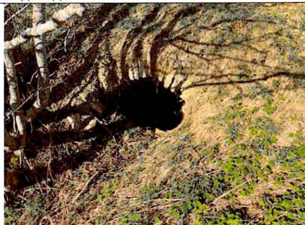
Фото 19. Вход в кирпичную галерею в месте разрушения
