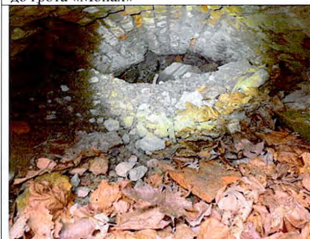
Фото 49. Кирпичный мост на Баурском канале – свод просел, проточность отсутствует
