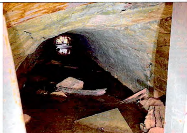
Фото 54. Свод моста на Баурском канале. Имеются вывалы камня.
