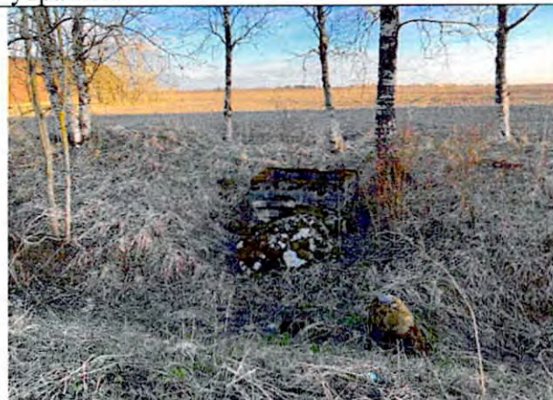
Фото 9. Обетонированный колодец для обслуживания водовода у базы СПБГУ в Новокондакопшино
