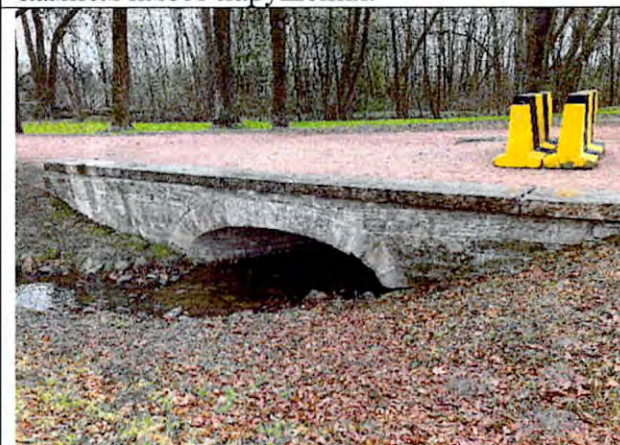
Фото 67. Мостик через канал на аллее. Известняковая облицовка верхового фасада. Имеется деструкция и трещины в камне
