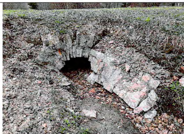
Фото 48. Кирпичный мост на Баурском канале в полуразрушенном состоянии, проточность отсутствует
