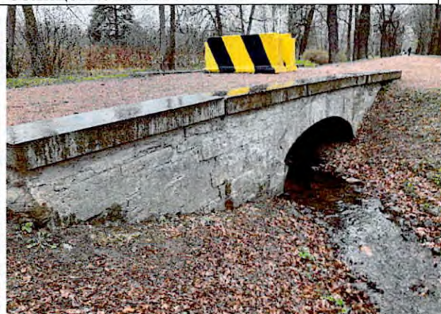
Фото 68. Мостик через канал на аллее. Известняковая облицовка низового фасада. Имеется трещина по фасаду
