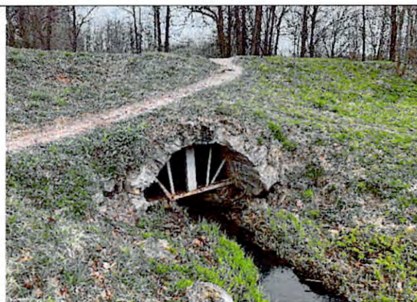
Фото 53. Каменный мост – акведук на Баурском канале. Разрушение облицовки фасада. Выполнены поддерживающие конструкции свода
