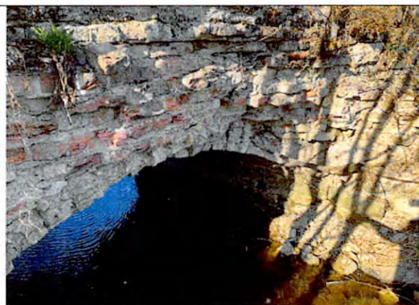
Фото 23. Акведук через р. Кузьминку, восточный фасад. Утрата известняковой облицовки, деструкция кирпичной кладки
