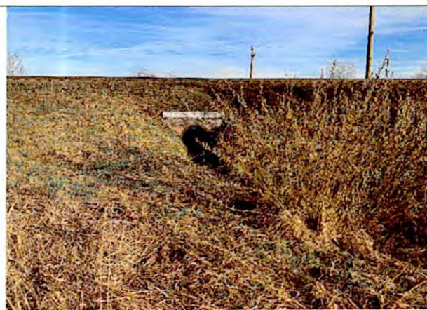
Фото 17. Труба под ж/д веткой на трассе водовода
