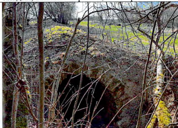
Фото 28. Вход в кирпичную галерею в месте разрушения
