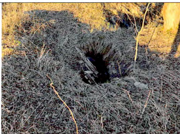
Фото 11. Провалы кирпичной галереи в Новокондакопшино
