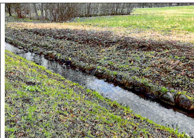
Фото 65. Мощение канала булыжным камнем имеет нарушения.
