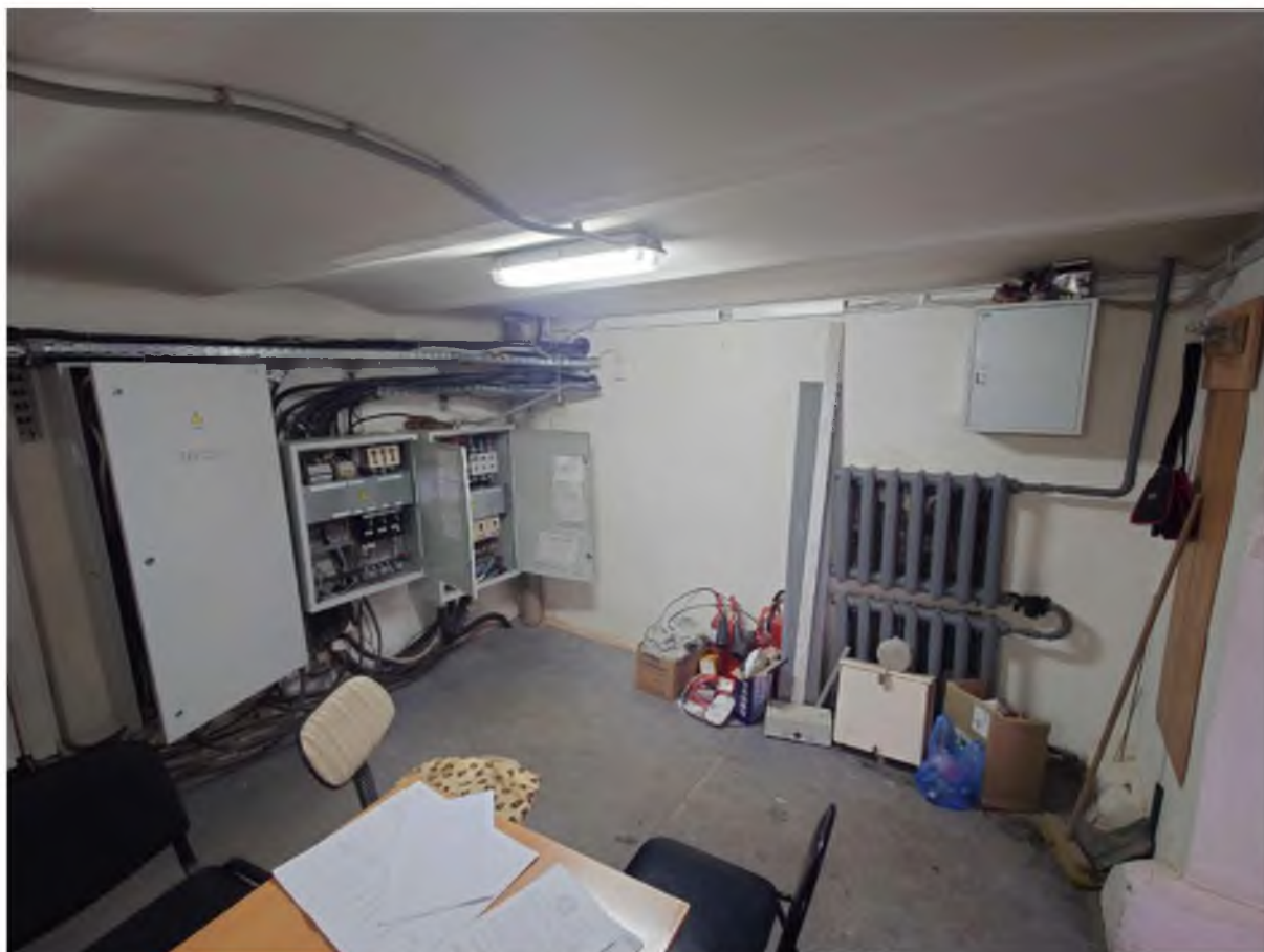
13. Вид на ГРЩ, ЩРА и ВРУ в пом.19.
