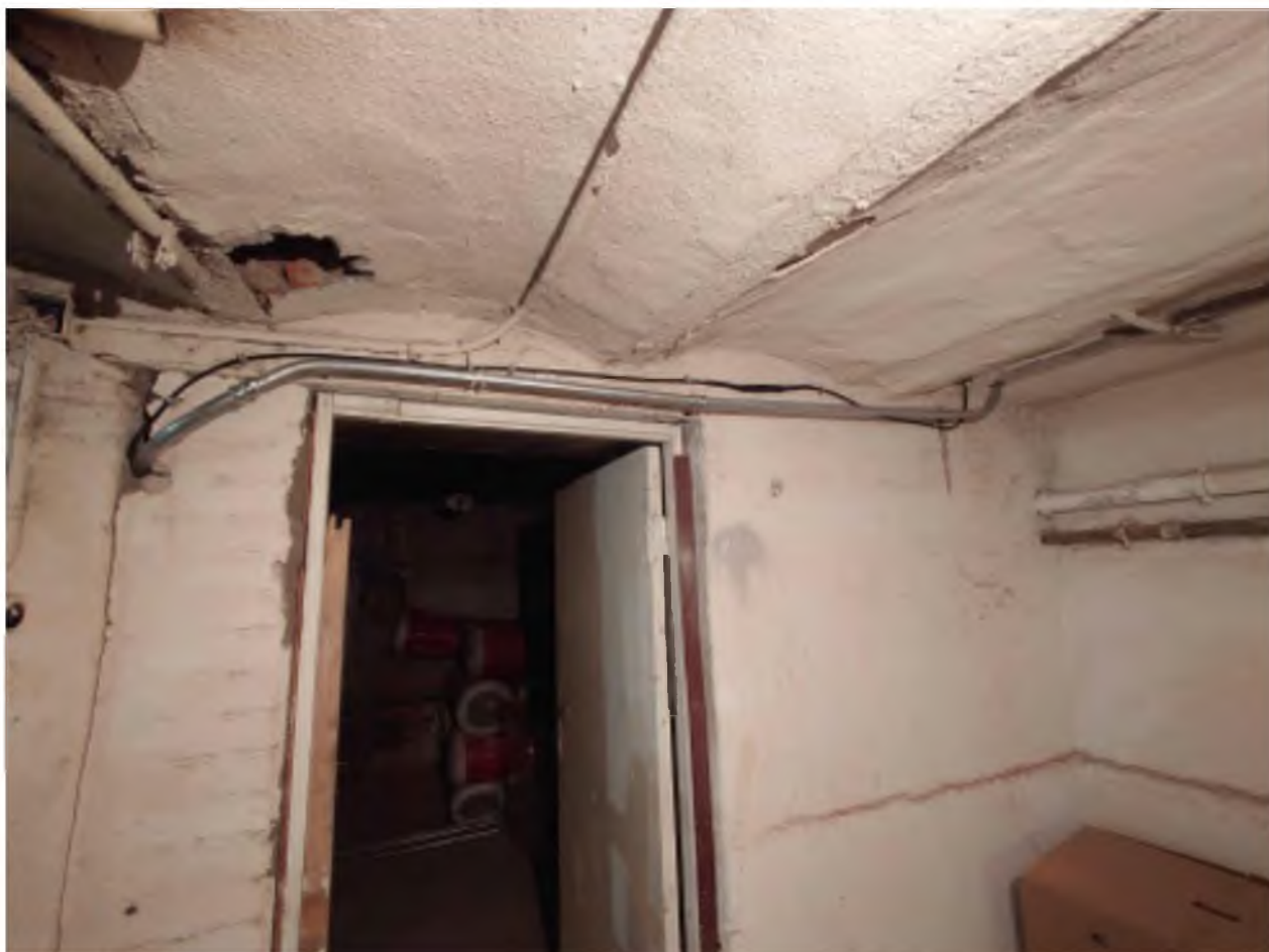
15. Фрагмент трассы электрических кабелей в пом.19.
