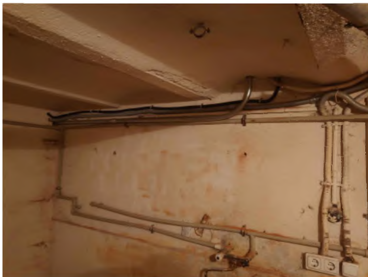
14. Фрагмент трассы электрических кабелей в пом.19.
