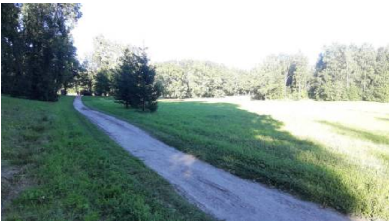
24. «Мост-плотина Висконтиев» (Санкт-Петербург, г. Павловск, Садовая ул., д. 20, лит. АК). Вид на Михайловскую аллею в сторону Пиль-башни. Наблюдаются вымочки на набивном покрытии, нарушение бровок и отсутствие придорожных лотков. Штиглиц М.С. 22.07.2026 г.
