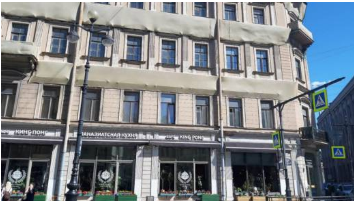
41. «Дом. Здесь в конце 1906 г. проходили заседания ЦК и ПК РСДРП» (наб. реки Мойки, д. 61, лит. А). Лицевой фасад. Фрагмент. Фото мест установки оборудования и прокладки кабельных трасс. Штиглиц М.С. 12.06.2026.
