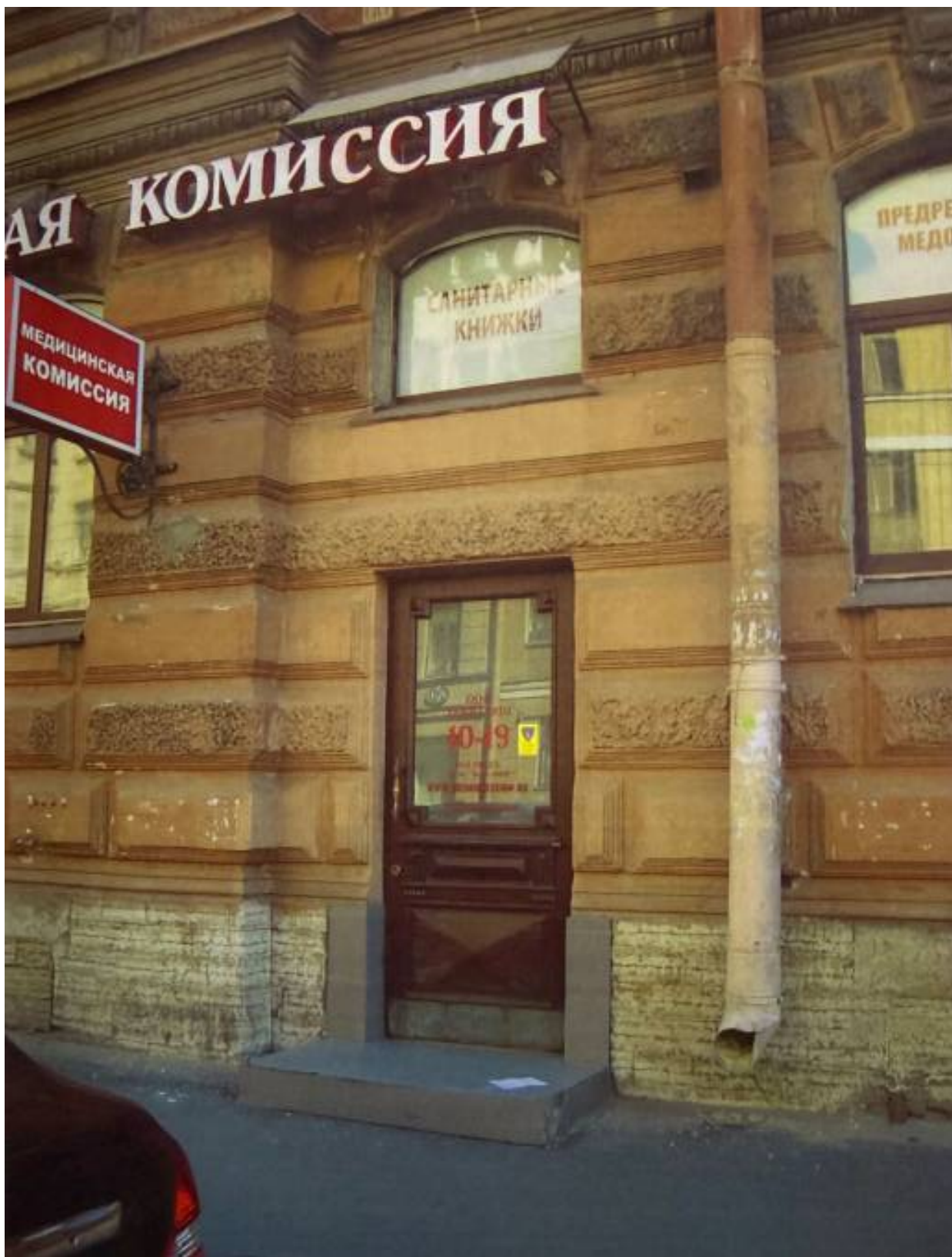
37. Дверной проем лицевого фасада. Фото. 14.06.2012. // Архив КГИОП. П. 1821. Н-12605. Акт по результатам государственной экспертизы объекта культурного наследия федерального значения «Дом, в котором жил музыкальный деятель М.П. Беляев, собирался кружок музыкантов и композиторов во главе с Н.А. Римским-Корсаковым. Здесь проходили музыкальные вечера «Беляевские пятницы» 1884-1903», расположенного по адресу: Санкт-Петербург, ул. Марата, д. 50. 2012 г.
