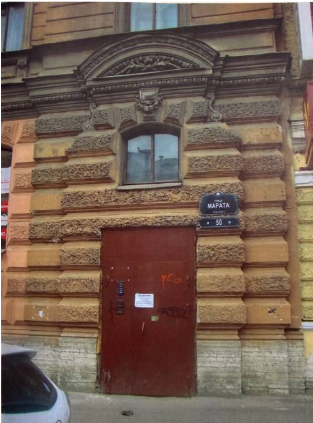
39. Дверной проем лицевого фасада. Фото. 14.06.2012. // Архив КГИОП. П. 1821. Н-12605. Акт по результатам государственной экспертизы объекта культурного наследия федерального значения «Дом, в котором жил музыкальный деятель М.П. Беляев, собирався кружок музыкантов и композиторов во главе с Н.А. Римским-Корсаковым. Здесь проходили музыкальные вечера «Беляевские пятницы» 1884-1903», расположенного по адресу: Санкт-Петербург, ул. Марата, д. 50. 2012 г.
