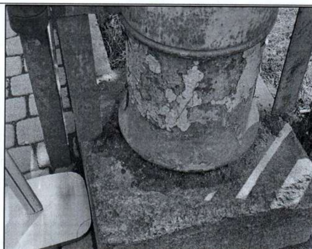
6. Коррозия металла, шелушения окрасочного слоя на металлических пушках в оформлении ворот и калиток.
