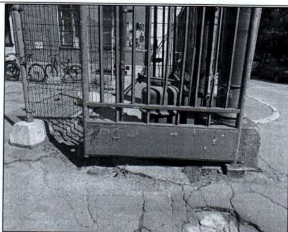
5. Коррозия металла, шелушения окрасочного слоя на металлических воротах и калитках, в нижней части.
