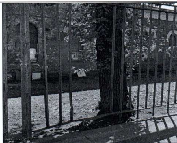
12. Механические повреждения, погнутости, деформации и утраты вертикальных и направляющих стоек металлической ограды
