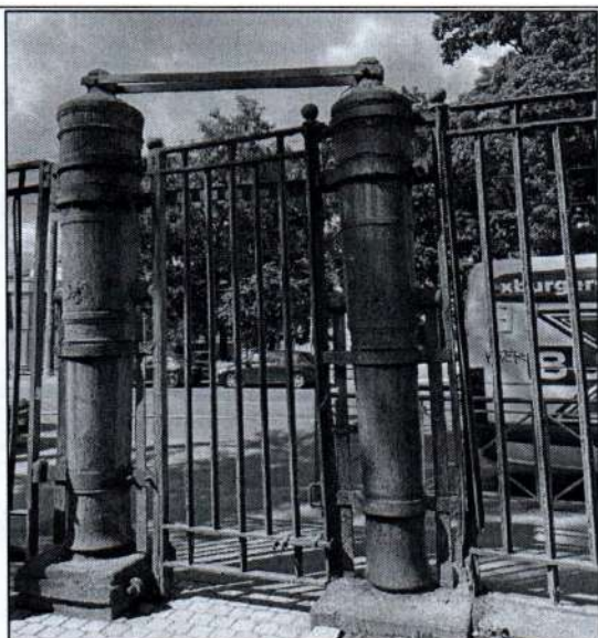
7. Сколы, выветривание шовного раствора, загрязнения, биопоражения гранитного цоколя.
