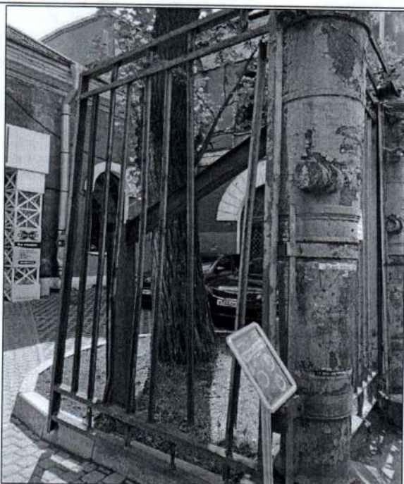
13. Утраты вертикальных стоек, коррозия металла, шелушения окрасочного слоя на чугунных стволах пушек.
