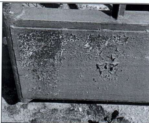
6. Коррозия металла, шелушения окрасочного слоя на металлических воротах и калитках, в нижней части.
