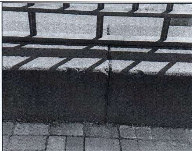
7. Сколы, выветривание шовного раствора, загрязнения, биопоражения гранитного цоколя.
