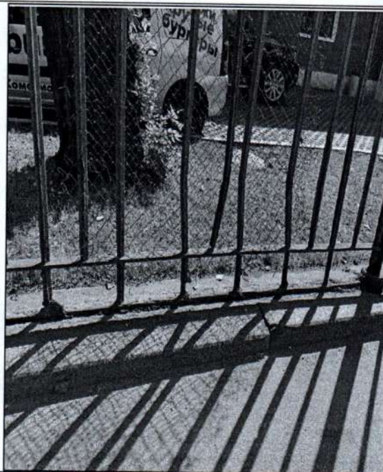
14. Деформации вертикальных и направляющих стоек, коррозия металла, шелушения окрасочного слоя. Пролет затянут сеткой «рабица».
