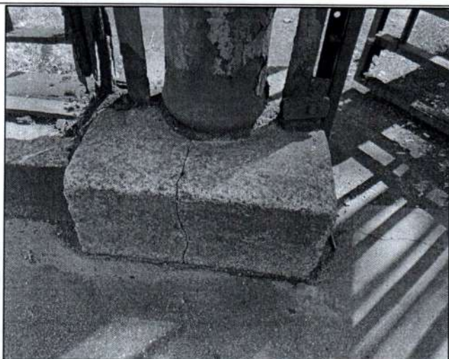
5. Сколы, трещины гранитных блоков в основании ограды с раскрытием > 5мм; выветривание шовного раствора, загрязнения, биопоражения.
