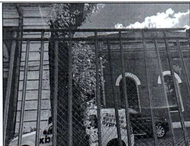
9. Деформации вертикальных и направляющих стоек, коррозия металла, шелушения окрасочного слоя. Пролет затянут сеткой «рабица».
