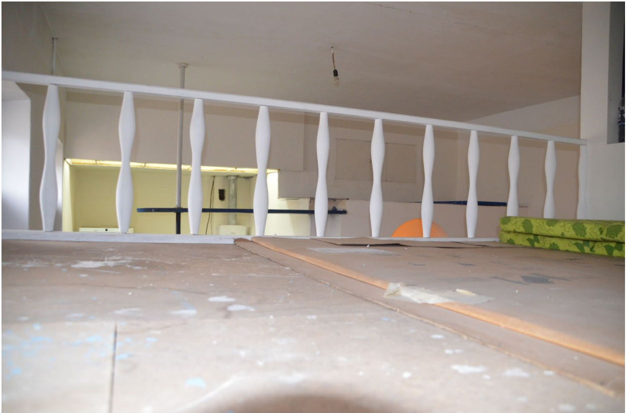
9. Помещение №1 кв. №11 в уровне 4-го этажа выявленного объекта культурного наследия «Дом Лесниковых», расположенного по адресу: г. Санкт-Петербург, пер. Сергея Тюленина, д. 4/23, литера А. 24.09.2025.
