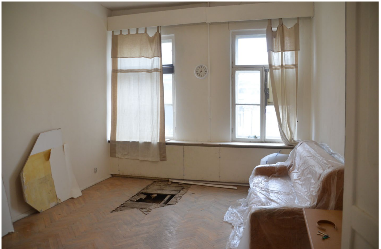
14. Помещение №2 кв. №11 в уровне 4-го этажа выявленного объекта культурного наследия «Дом Лесниковых», расположенного по адресу: г. Санкт-Петербург, пер. Сергея Тюленина, д. 4/23, литера А. 24.09.2025.
