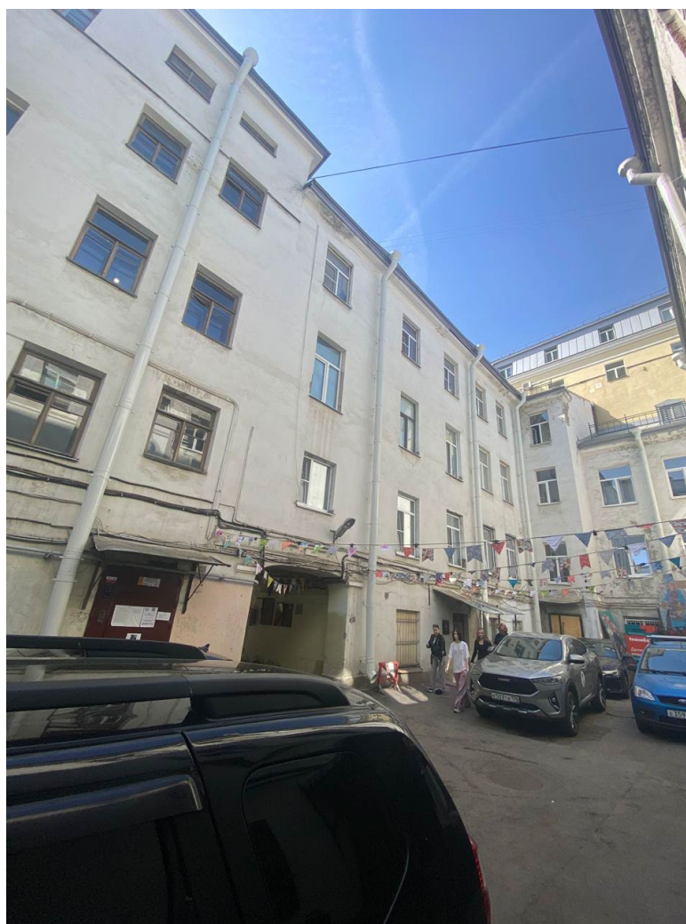
12. Дворовый фасады объекта культурного наследия регионального значения «Дом Ф.А. Голицына (Э. Паннаша)», расположенный по адресу: г. Санкт-Петербург, 16-я линия В.О., д. 1/33, литера А. Фрагмент. 27.05.2026
