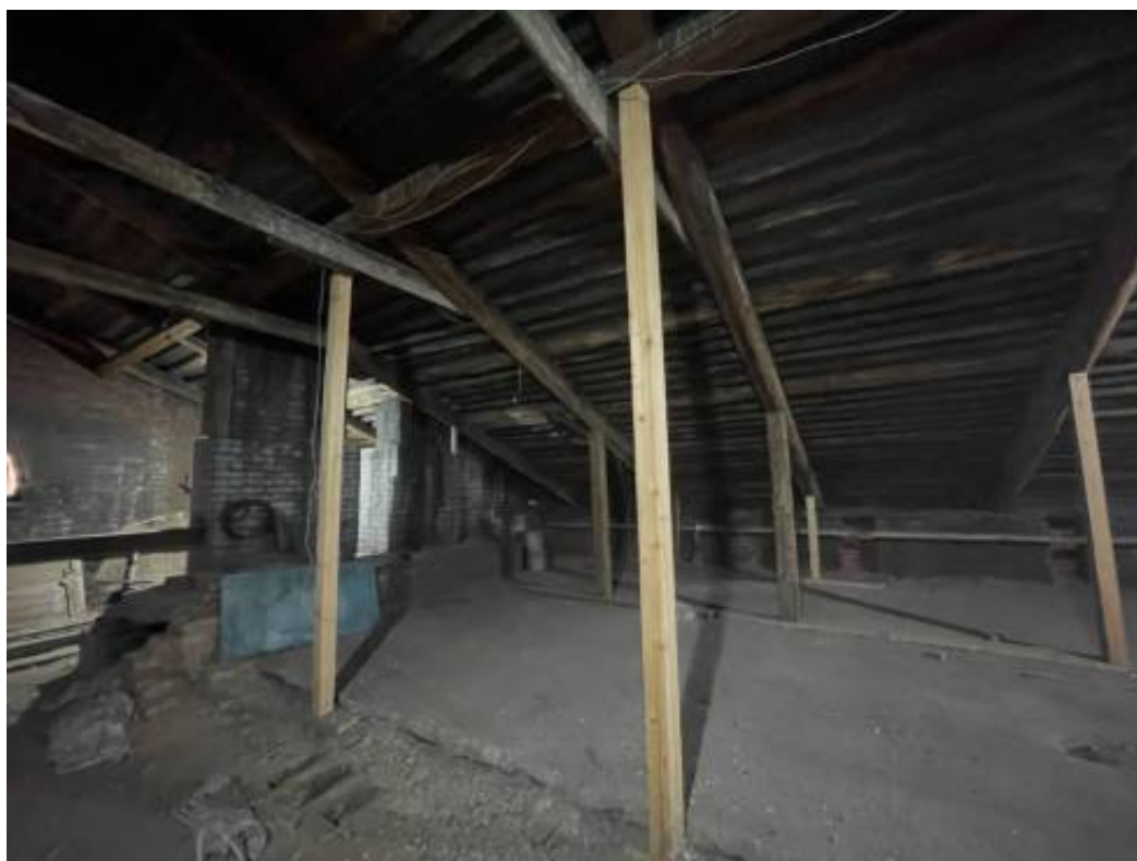
Фото 86. Интерьер чердака объекта культурного наследия регионального значения «Гараж (корпус 266)», входящего в состав объекта культурного наследия регионального значения «Комплекс товарищества Российско-Американской резиновой мануфактуры «Треугольник»
