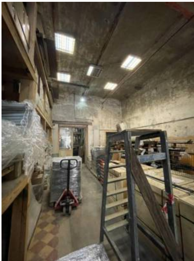
Фото 17. Интерьер 1 этажа объекта культурного наследия регионального значения «Гараж (корпус 266)», входящего в состав объекта культурного наследия регионального значения «Комплекс товарищества Российско-Американской резиновой мануфактуры «Треугольник»
