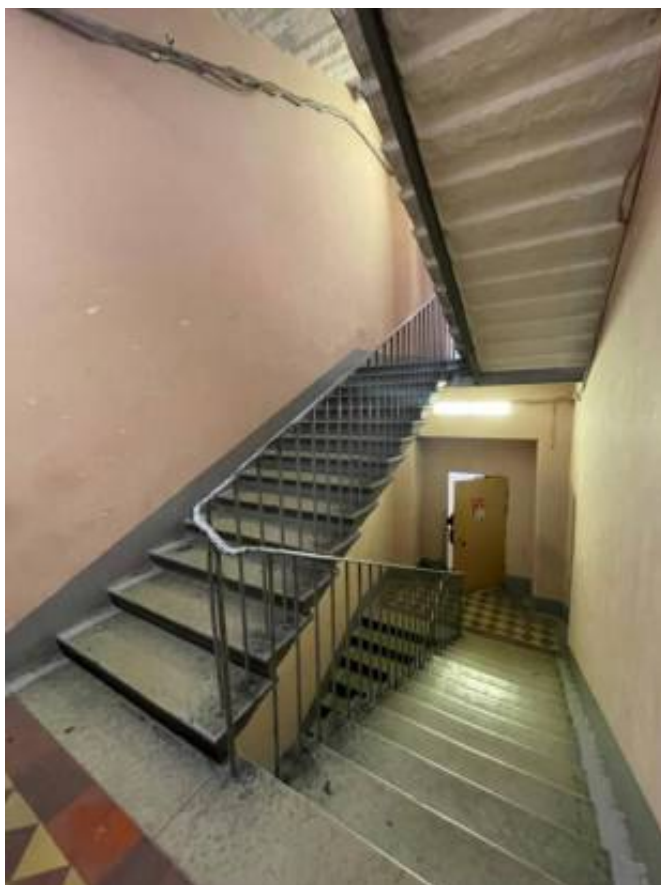
Фото 27. Интерьер 2 этажа объекта культурного наследия регионального значения «Гараж (корпус 266)», входящего в состав объекта культурного наследия регионального значения «Комплекс товарищества Российско-Американской резиновой мануфактуры «Треугольник»
