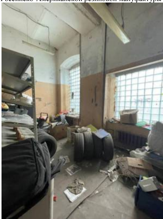
Фото 12. Интерьер 1 этажа объекта культурного наследия регионального значения «Гараж (корпус 266)», входящего в состав объекта культурного наследия регионального значения «Комплекс товарищества Российско-Американской резиновой мануфактуры «Треугольник»
