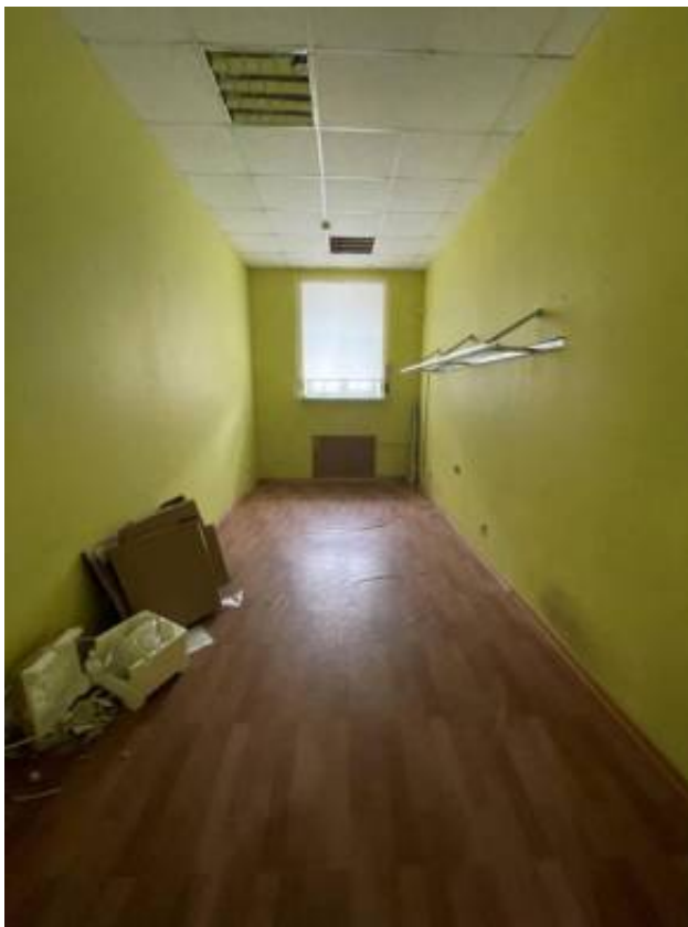
Фото 41. Интерьер 2 этажа объекта культурного наследия регионального значения «Гараж (корпус 266)», входящего в состав объекта культурного наследия регионального значения «Комплекс товарищества Российско-Американской резиновой мануфактуры «Треугольник»
