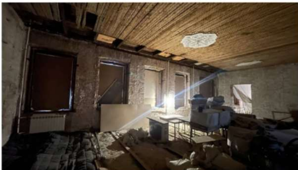
Илл. 29. Объект культурного наследия регионального значения «Особняк Л.Н. Симонова (Столыпиных)», расположенный по адресу: Санкт-Петербург, Гагаринская ул., 5, лит. А. Общий вид помещения в осях 3-5/А-Б с демонтированными перегородками и отделочными слоями.
