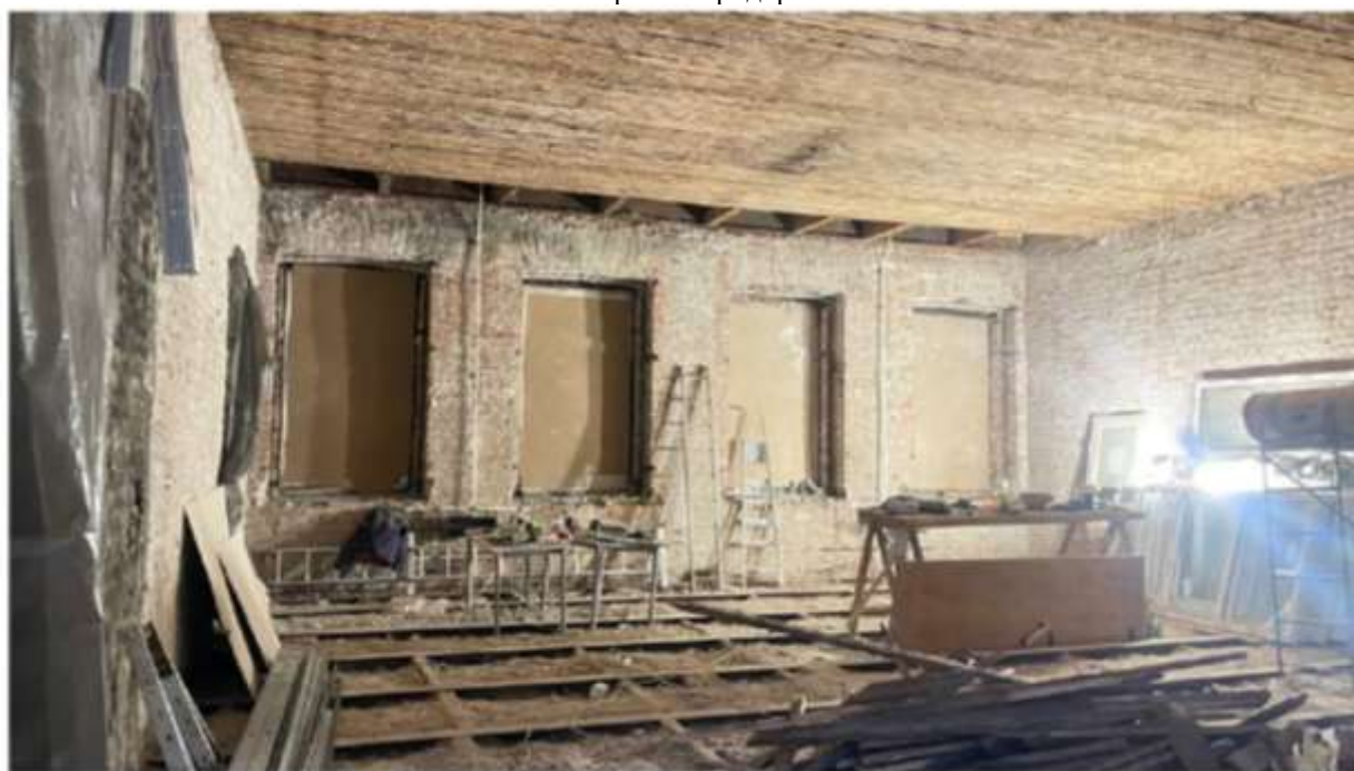
Илл. 25. Объект культурного наследия регионального значения «Особняк Л.Н. Симонова (Столыпиных)», расположенный по адресу: Санкт-Петербург, Гагаринская ул., 5, лит. А. Общий вид помещения в осях 1-3/А-В с демонтированными перегородками и отделочными слоями.
