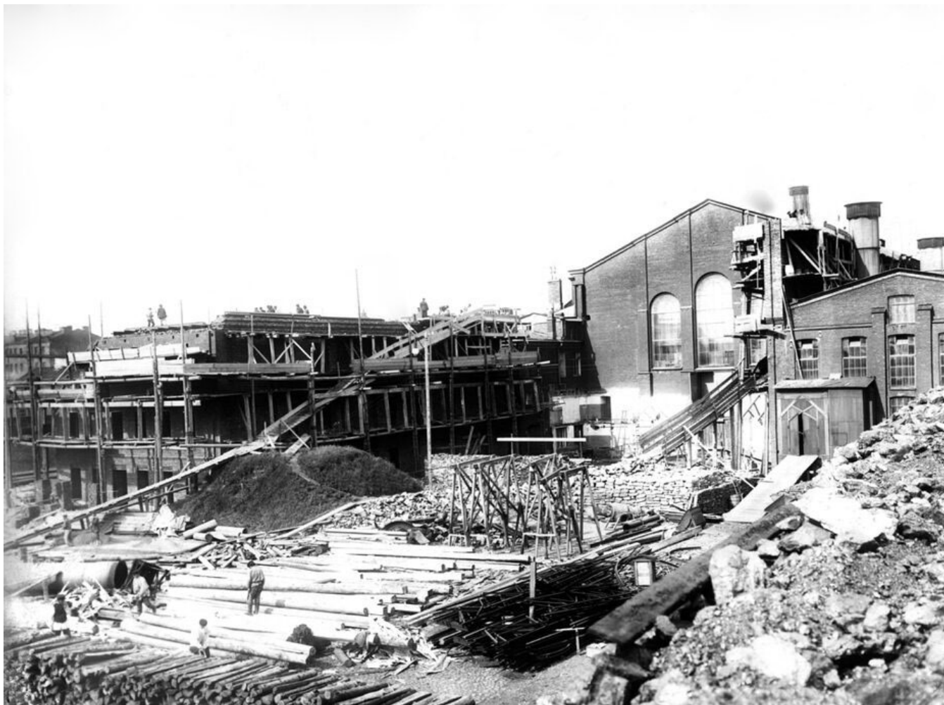
Рис. 20. Расширение и реконструкция Центральной электростанции «Общества электрического освещения 1886 г.» (1906–1907), Россия, Санкт-Петербург, Московский район СПб, округ Московская застава.
