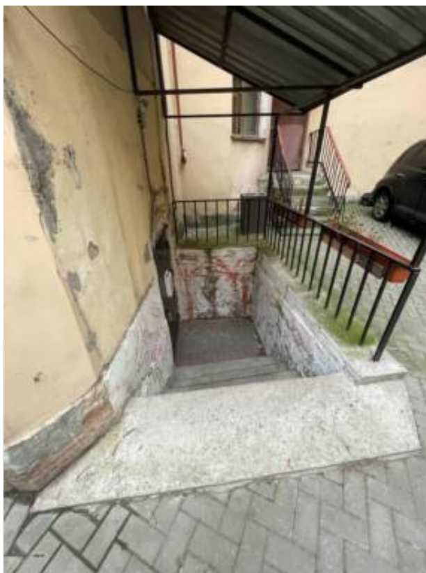
Фото 7. Фрагмент дворового фасада выявленного объекта культурного наследия «Дом А. Эрке», вход в пом. 2-Н
