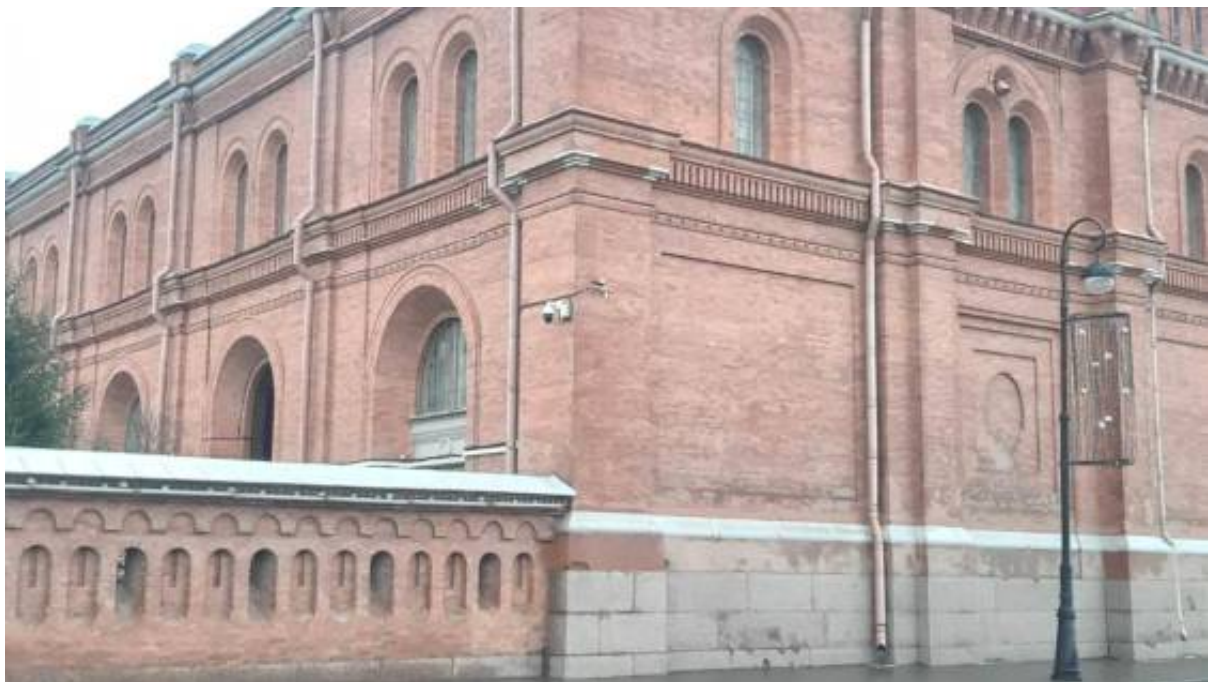
26. «Арсенал (в составе «Кронверк Петропавловской крепости»)». (Александровский парк, д. 7, лит. А). Фрагмент лицевого фасада. Фото мест установки оборудования и прокладки кабельных трасс. Штиглиц М.С. 17.12.2025.
