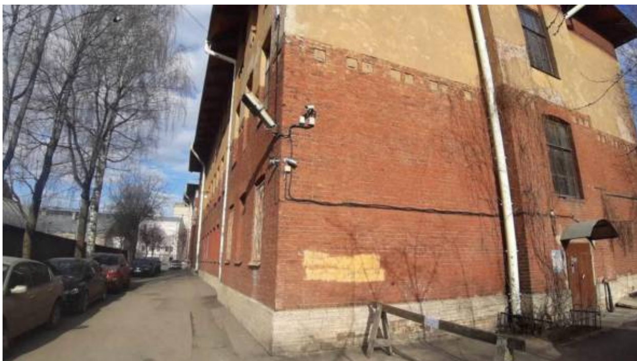
32. «Казарменный корпус» (в составе «Казарменные, административные и хозяйственные корпуса», в составе «Здания Санкт-Петербургской бригады пограничной стражи») (Красного Курсанта, дом 34, литера Б). Дворовый фасад. Фото мест установки оборудования и прокладки кабельных трасс. Штиглиц М.С. 03.04.2026.
