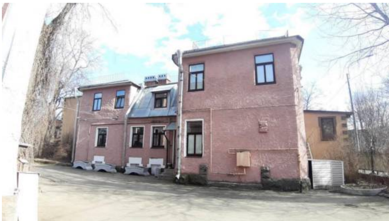
38. «Служебный флигель» (в составе «Особняк Ф.И. Андреевского») (Ольгина ул., д. 2, лит. Б). Дворовые фасады. Фото мест установки оборудования и прокладки кабельных трасс. Штиглиц М.С. 02.04.2026 г.
