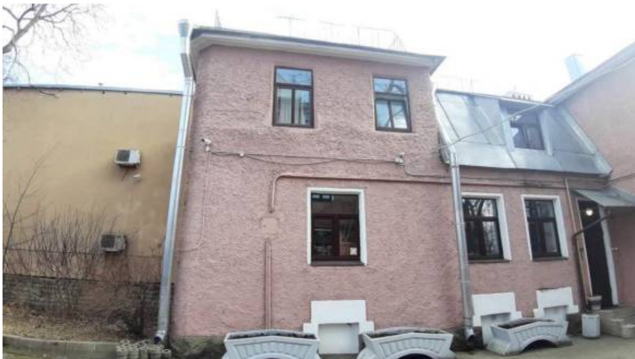
39. «Служебный флигель» (в составе «Особняк Ф.И. Андреевского») (Ольгина ул., д. 2, лит. Б). Дворовые фасады. Фото мест установки оборудования и прокладки кабельных трасс. Штиглиц М.С. 02.04.2026 г.
