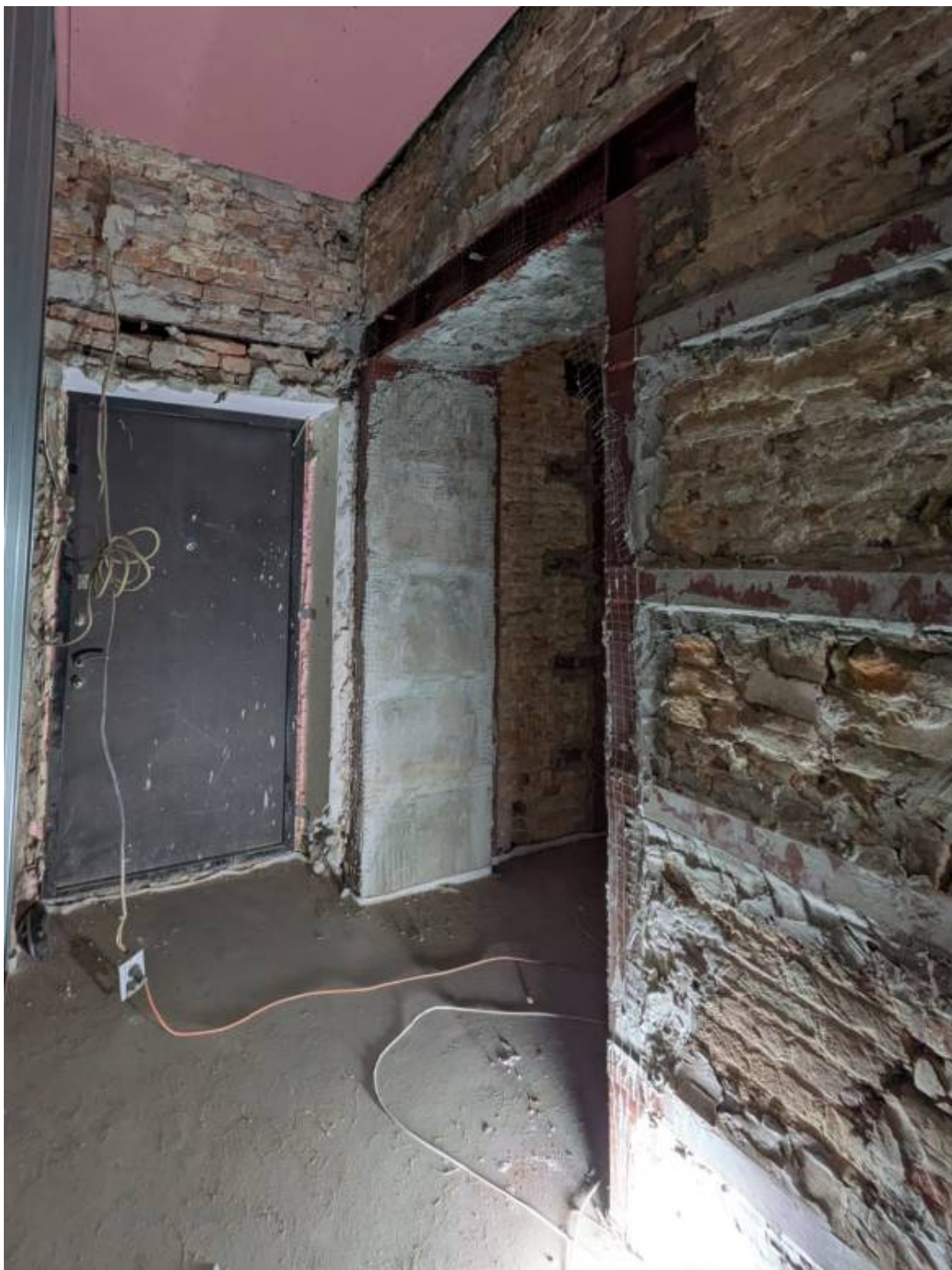
15. Входная дверь квартиры 37.
