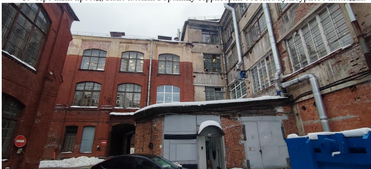
6. Включаемая в границы территории объекта культурного наследия часть здания со стороны внутреннего двора.
