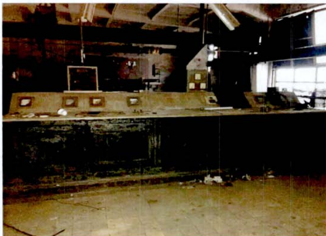
Фото 12. Пульт управления в бывш. турбинном зале.
