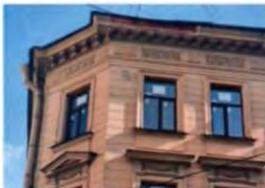
3. Фрагмент карниза. Деструкция отделочных слоев в т. ч. до оголения кирпичной кладки. (25.09.2023)
