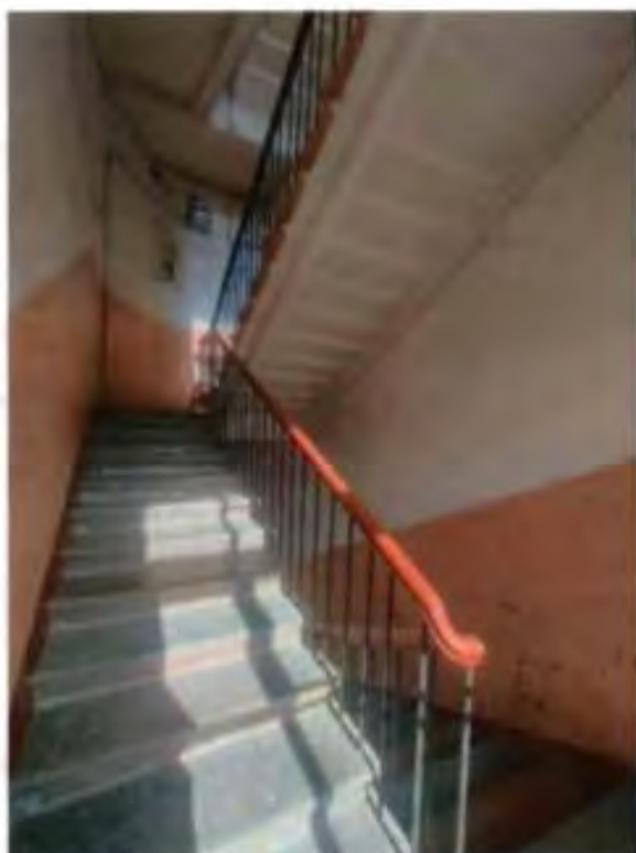
38. Лестничная клетка 4-ЛК. Шелушение окрасочного слоя стен. (25.09.2023)
