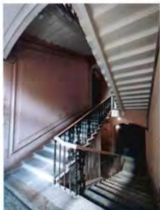
27. Лестничная клетка 3-ЛК. Утрата и замена ажурных стоек ограждения. (25.09.2023)
