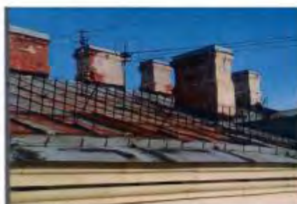
12. Фрагмент кровли. Коррозия металла. Деструкция отделочных слоев воздуховодов. (25.09.2023)
