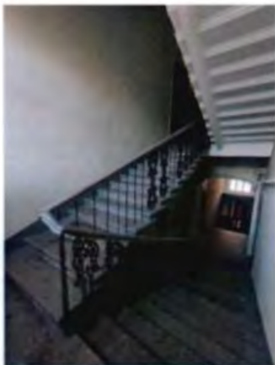
19. Лестничная клетка 1-ЛК. Утрата и замена ажурных стоек ограждения. (25.09.2023)
