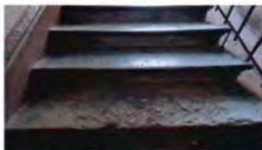
26. Ступени 3-ЛК. Сколы, трещины, истертости. (25.09.2023)
