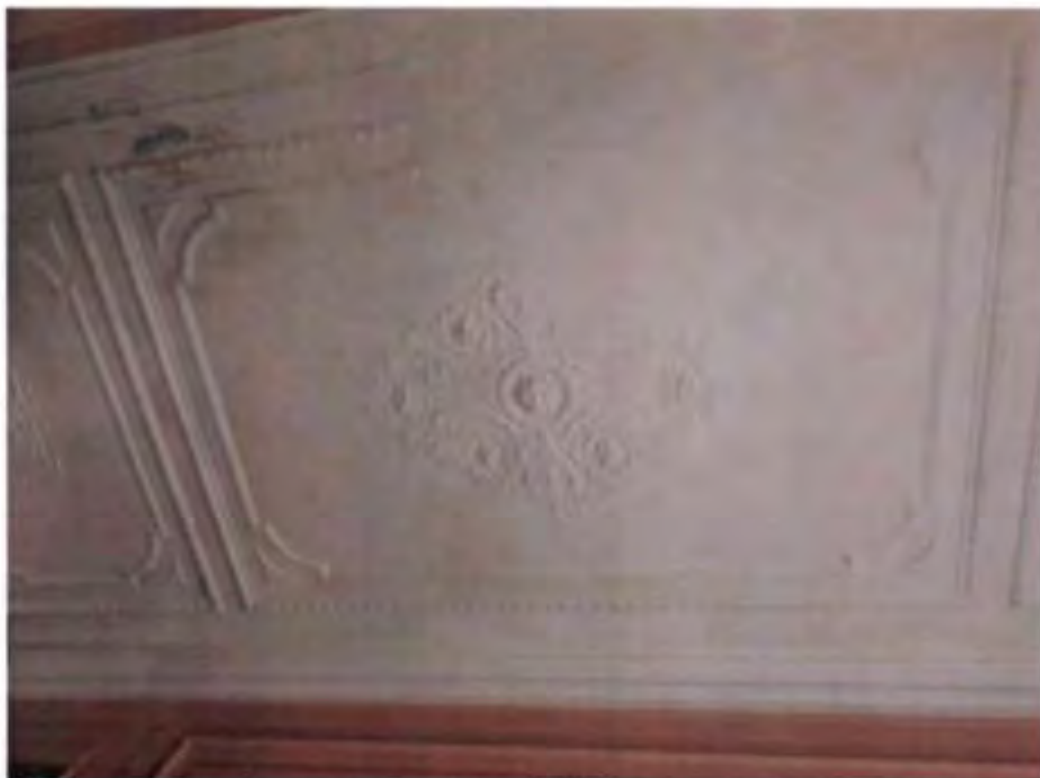
29. Оформление плафона верхней площадки 3-ЛК. Фрагментарная утрата деталей декора. Трещины и шелушения окрасочных слоев. (25.09.2023)
