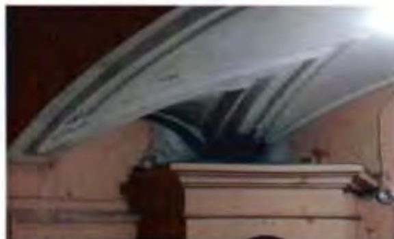
24. Потолок вестибюля 3-ЛК. Деструкция отделочных слоев над печью-камином. (25.09.2023)
