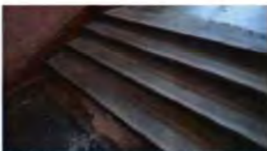
25. Известняковые ступени вестибюля 3-ЛК залиты бетоном. (25.09.2023)
