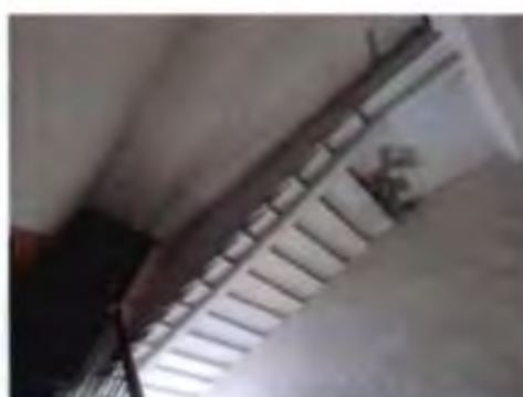
37. Лестничная клетка 4-ЛК. Шелушение и растрескивание окрасочного слоя. Следы протечек. (25.09.2023)
