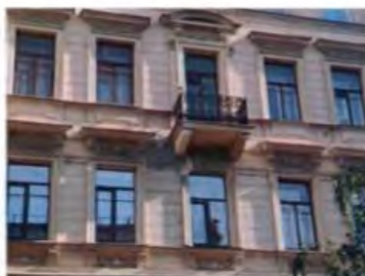
7. Фрагмент западного фасада. Фрагментарные участки утраты декора. (25.09.2023)
