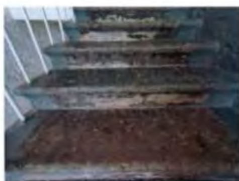
36. Ступени 2-ЛК. Сколы, трещины. (25.09.2023)
