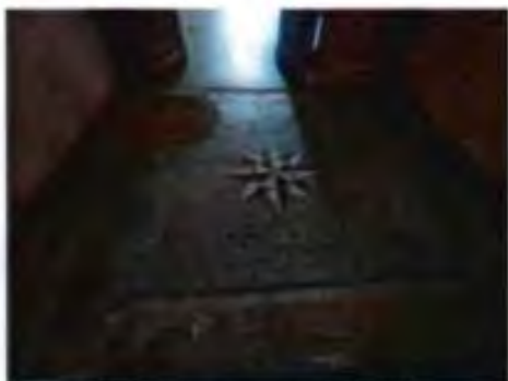
23. Покрытие полов 3-ЛК. Сколы, трещины. (25.09.2023)
