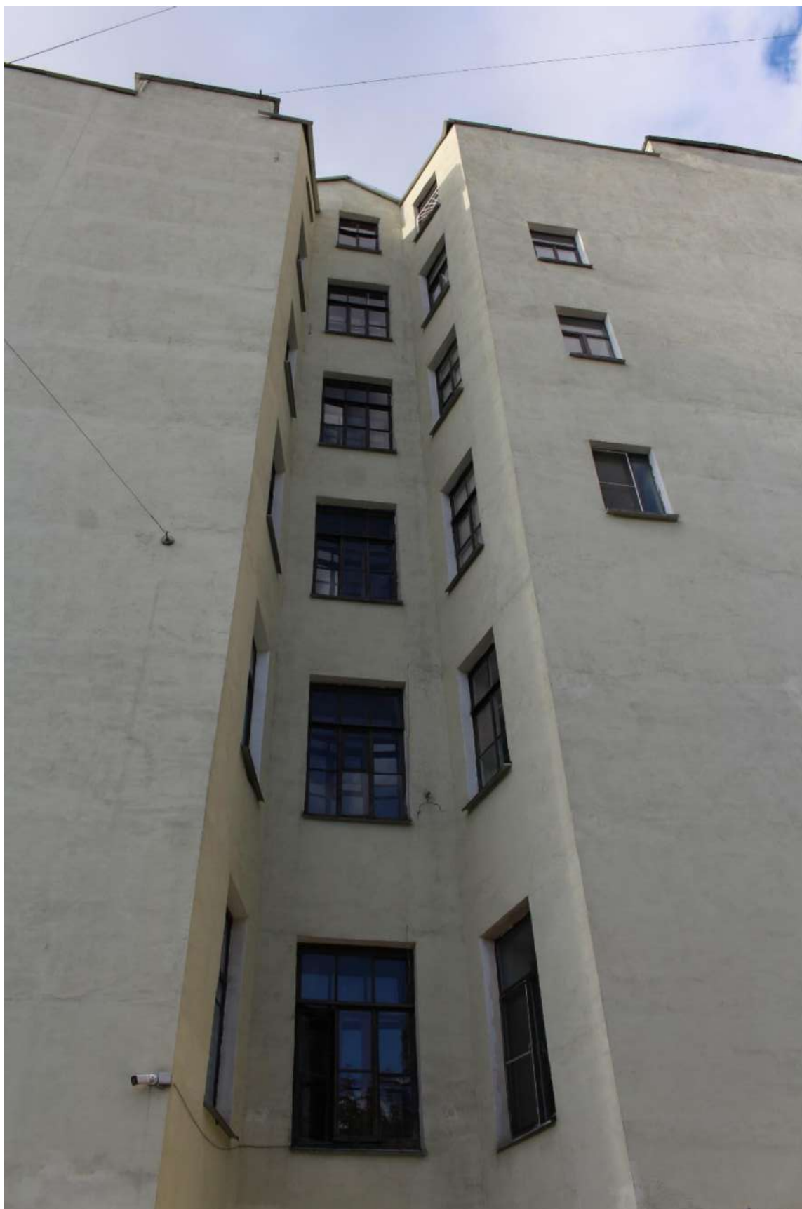
Фото 8. Вид на брандмауэр объекта культурного наследия регионального значения «Дом П.М. Станового» по Старорусской улице.
