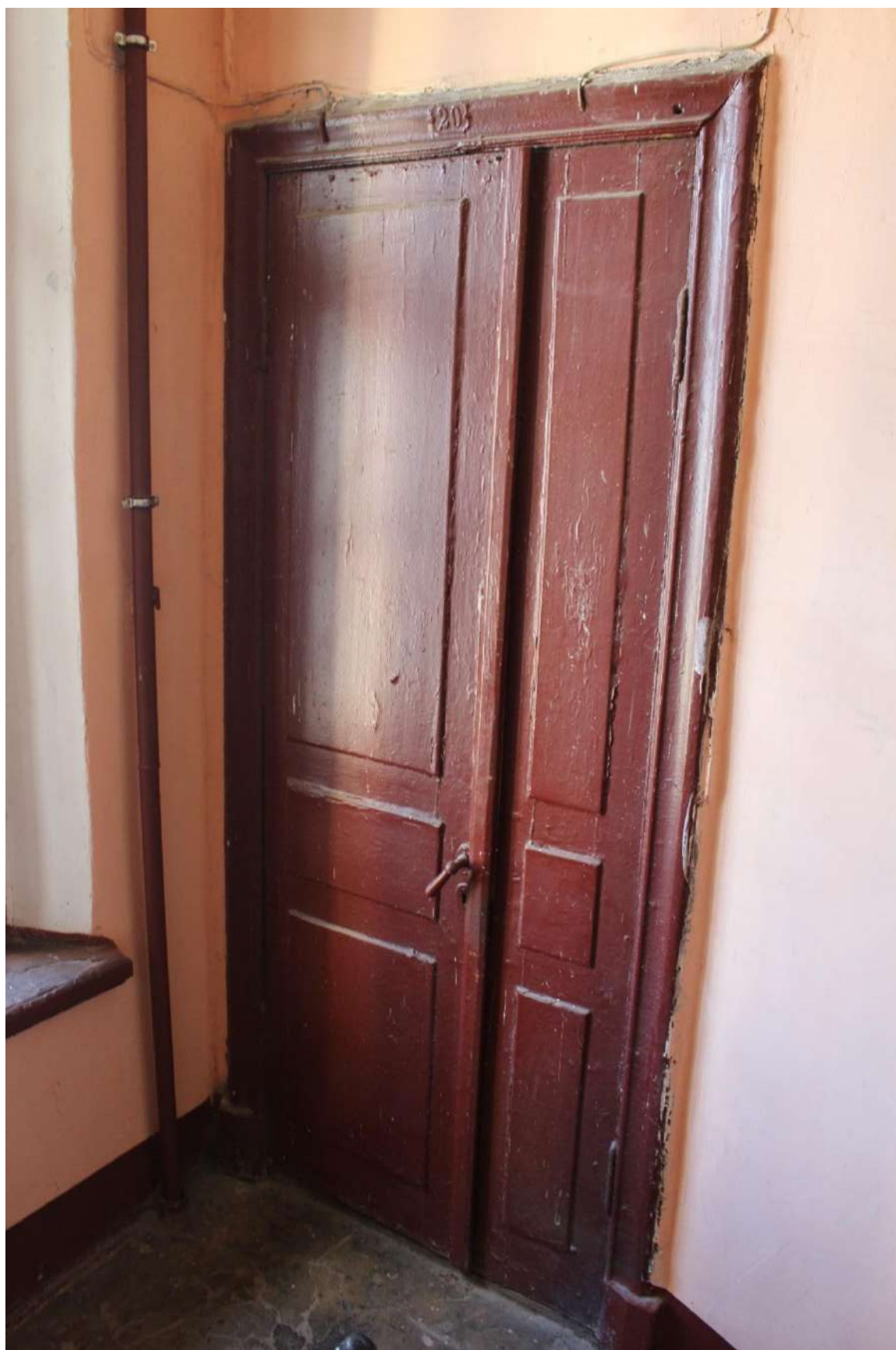
Фото 36. Объект культурного наследия регионального значения «Дом П.М. Станового». Вход в квартиру № 20 со стороны 5ЛК.
