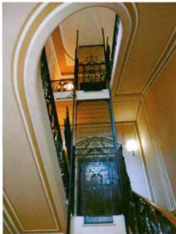
13. Кованое ограждение шахты лифта
