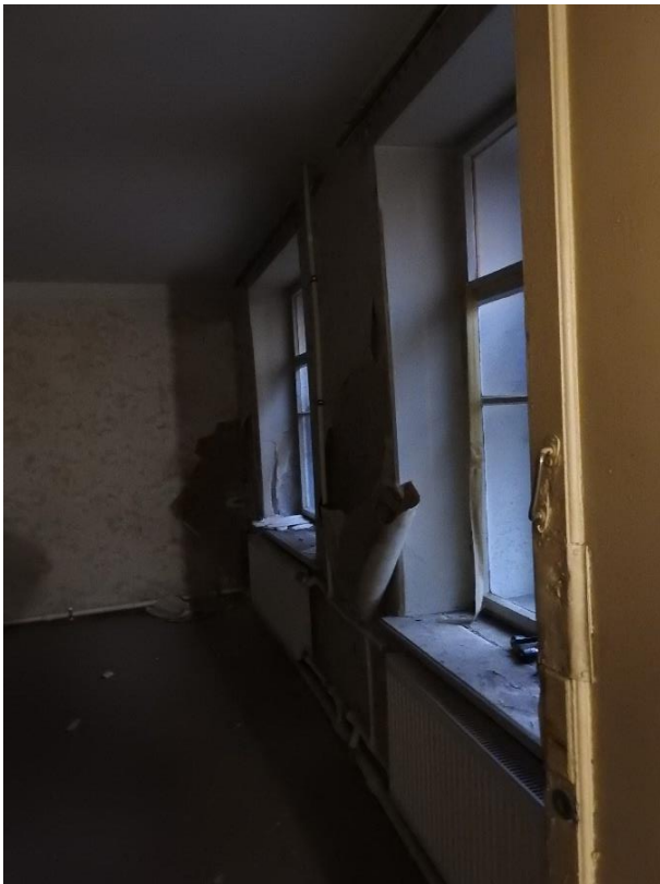
17. «Дом Чешихина», наб. Крюкова кан., д. 9. Первый этаж. Помещение №7 (согласно «Техническому паспорту на квартиру» с инв. №2770/18 от 13.08.2018). Общий вид. Фото 19.11.2025г.
