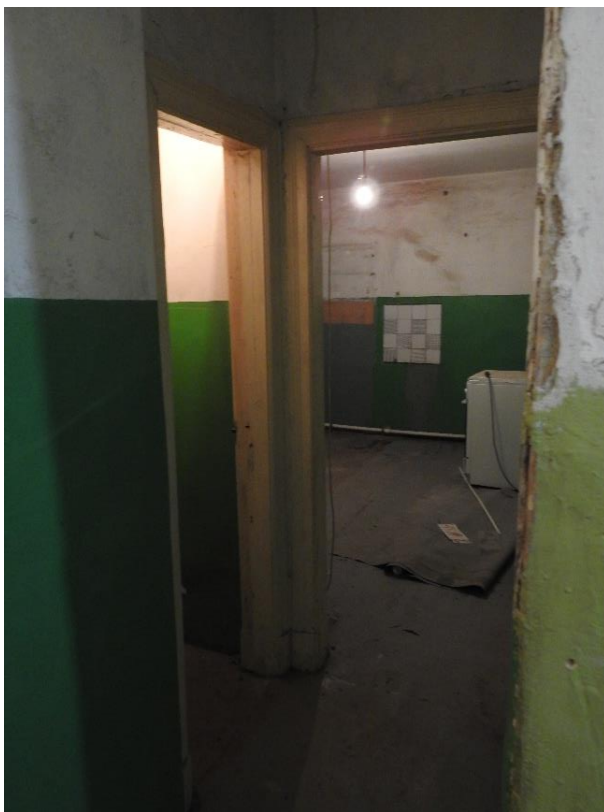
20. «Дом Чехихина», наб. Крюкова кан., д. 9. Первый этаж. Помещение №1 (согласно «Техническому паспорту на квартиру» с инв. №2770/18 от 13.08.2018). Фрагмент. Фото 19.11.2025г.
