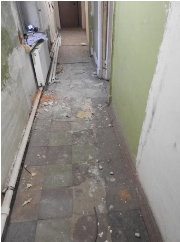
7. «Дом Чехихина», наб. Крюкова кан., д. 9. Первый этаж. Помещение №1 (согласно «Техническому паспорту на квартиру» с инв. №2770/18 от 13.08.2018). Общий вид. Фото 19.11.2025г.
