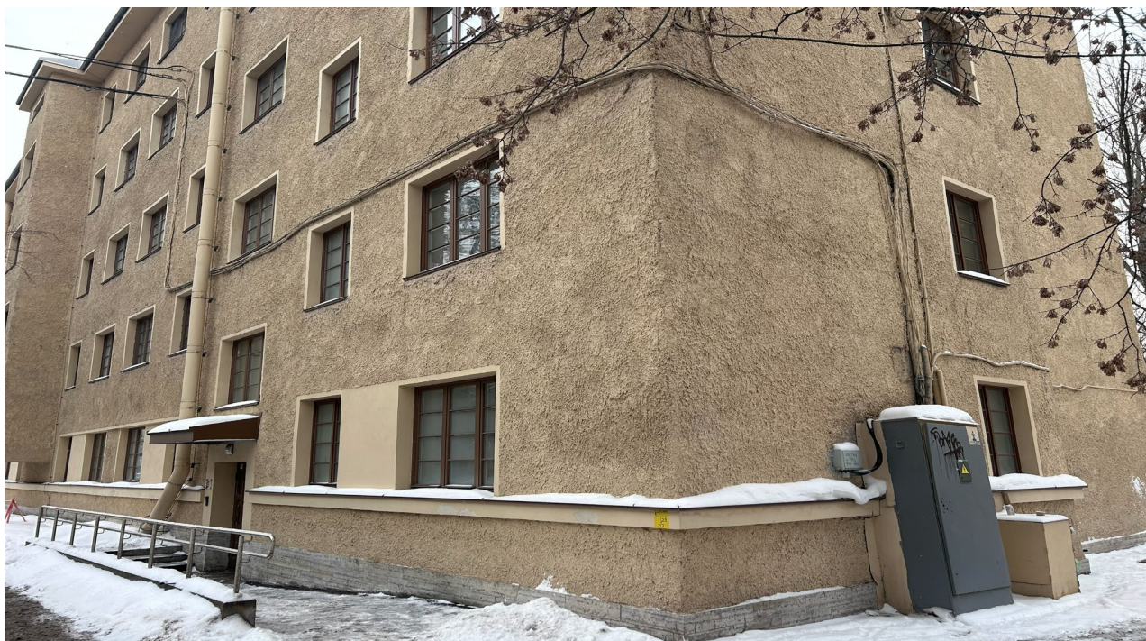
Фото 7. Существующий ПП и кабельная линии со стены Кондратьевский 40 к 11 литера А
