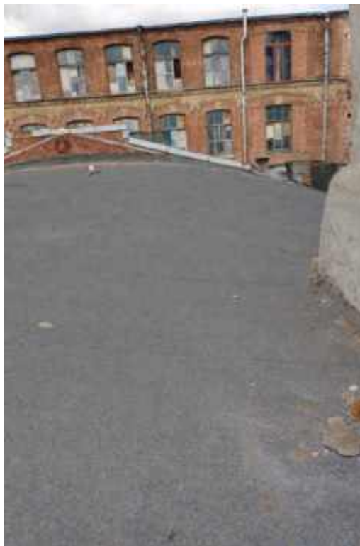
Фото 3. Вид на крышу объекта культурного наследия регионального значения «Конторское здание», входящего в состав объекта культурного наследия регионального значения «Постройки товарищества механического производства обуви «Скорород»
