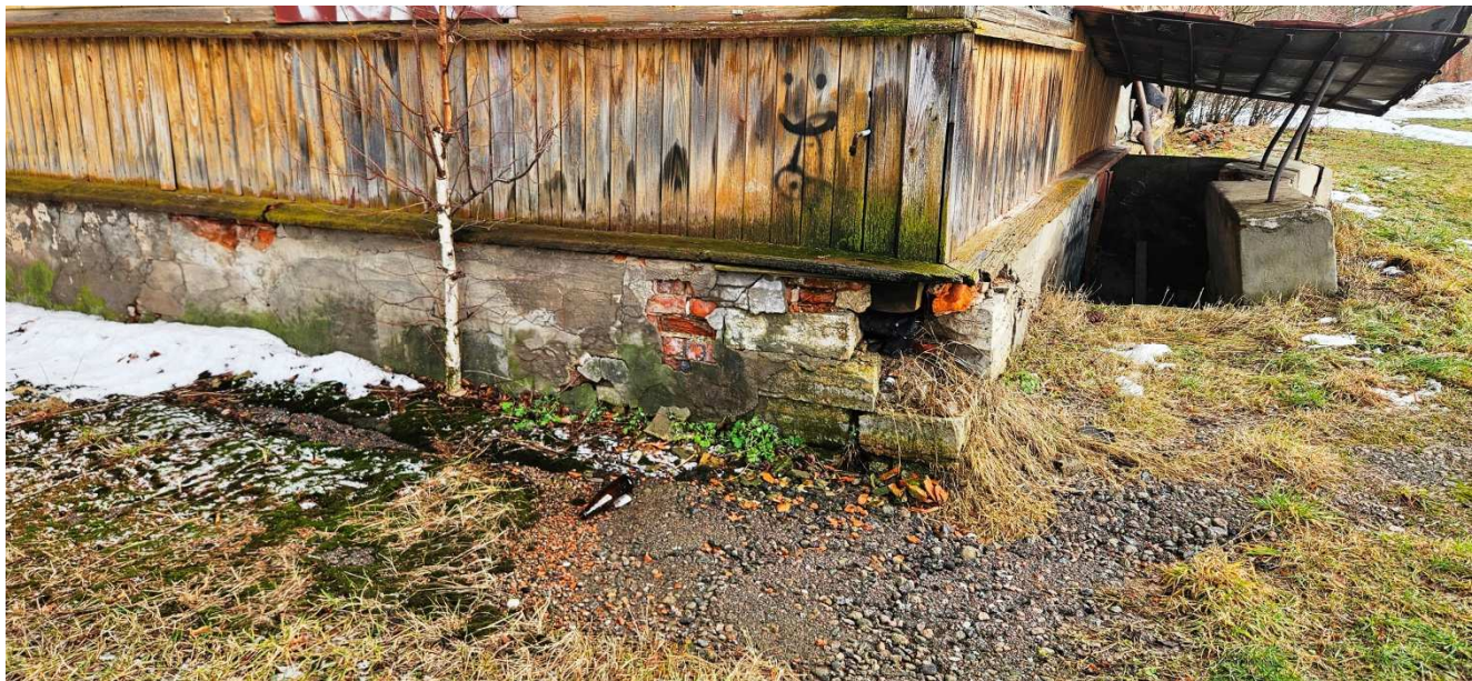
9. Выявленный объект культурного наследия «дом Н. Шарубина(?)». Фрагмент цоколя западного фасада.
