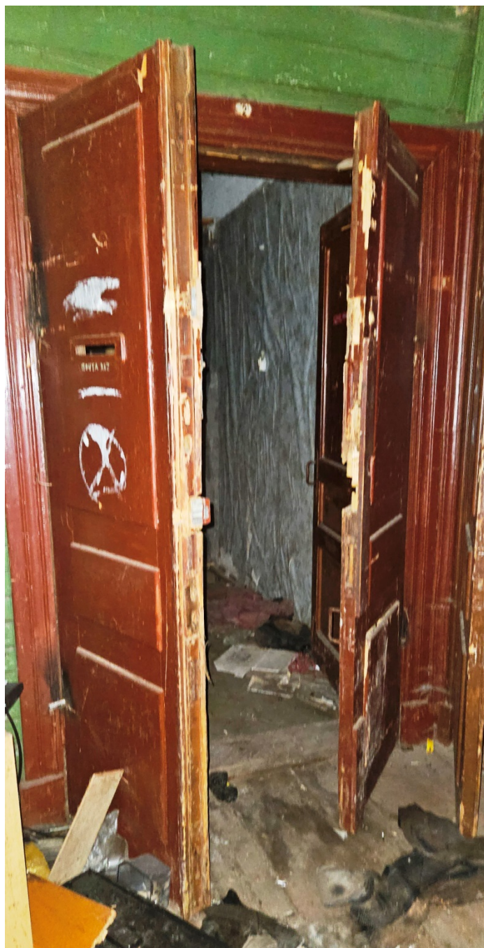
11. Выявленный объект культурного наследия «дом Н. Шарубина(?)». 1-й этаж. Входные двери в пом.1.
