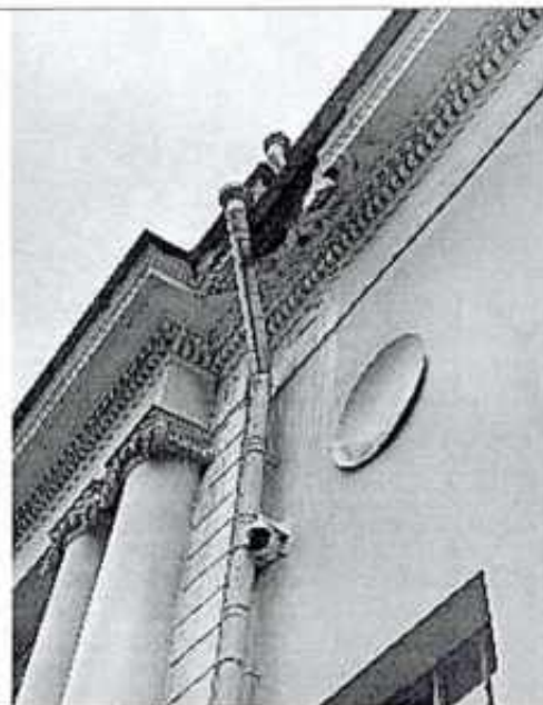
Фото 5. Фрагмент деструкции карнизного свеса (по Инженерной ул.)
